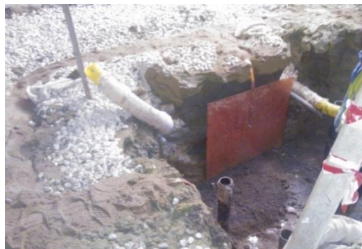
Figura 126 – Rede de terras no poço de bombagem
