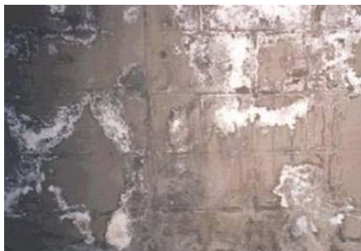
Figura 14 – Efflorescências - Deposição à superfície de sais dissolvidos pela percolação de água no interior do betão
