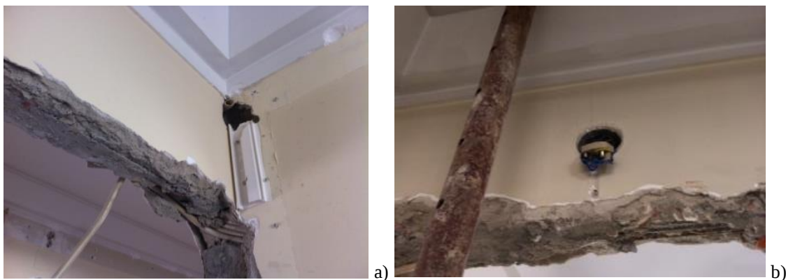
Figura 89 – Sondagem efetuada nas vigas dos pisos superiores onde se verifica a inclusão de instalação elétrica: a) tubagem e cabos; b) caixas
