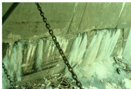
Figura 13 – Infiltração de água numa junta de betonagem deficiente
