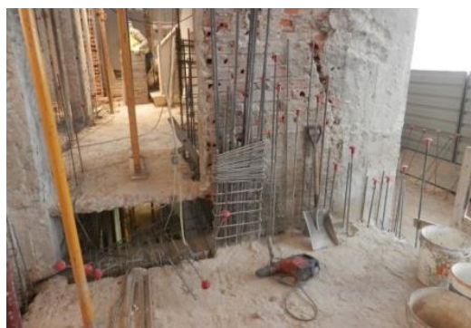
Figura 160 – Diferença de cotas entre lajes existentes antes da intervenção
