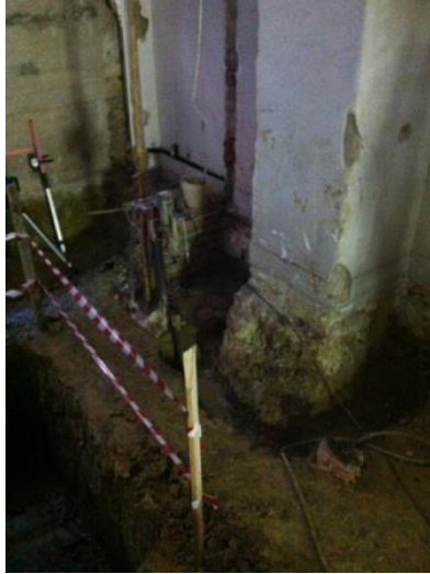
Figura 117 – Pilar sem sapata
