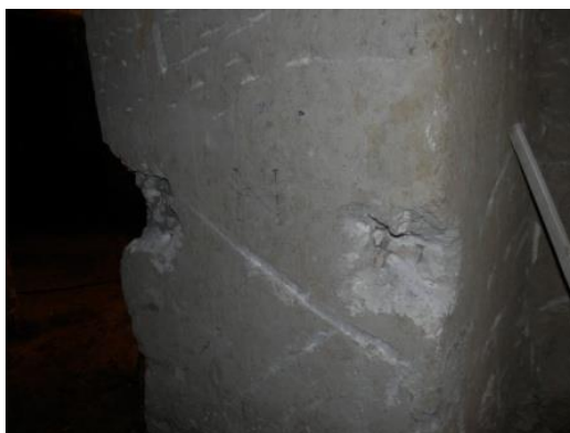
Figura 85 – Sondagem efetuada num pilar da cave onde não se observa a presença de armadura
