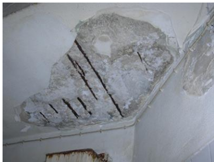
Figura 6 - Delaminação de betão em laje por corrosão de armaduras
