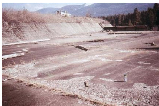
Figura 12 – Desagregação do betão - Desintegração sucessiva das camadas superficiais do betão
