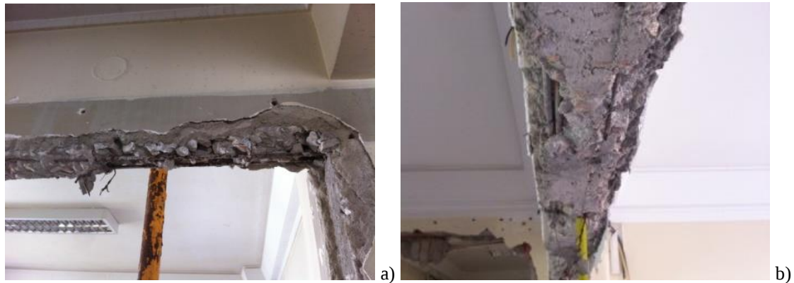
Figura 88 – Sondagem efetuada nas vigas dos pisos superiores onde se verifica: a) a existência de agregados de elevada dimensão; b) a ausência de recobrimento e o estado de corrosão
