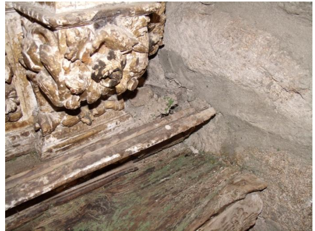
Fig. 84 Madeira dos tampos da mesa de altar bastante degradados (retábulo lado Epístola).
