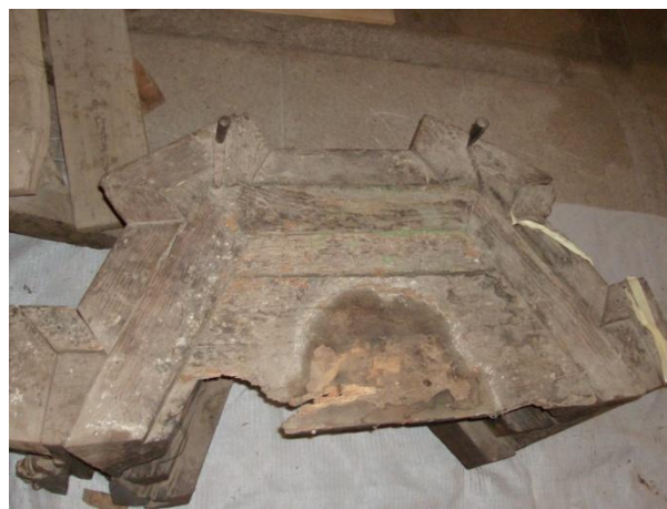
Fig. 168 Estado das madeiras dos tampos dos degraus do Trono Celestial.
