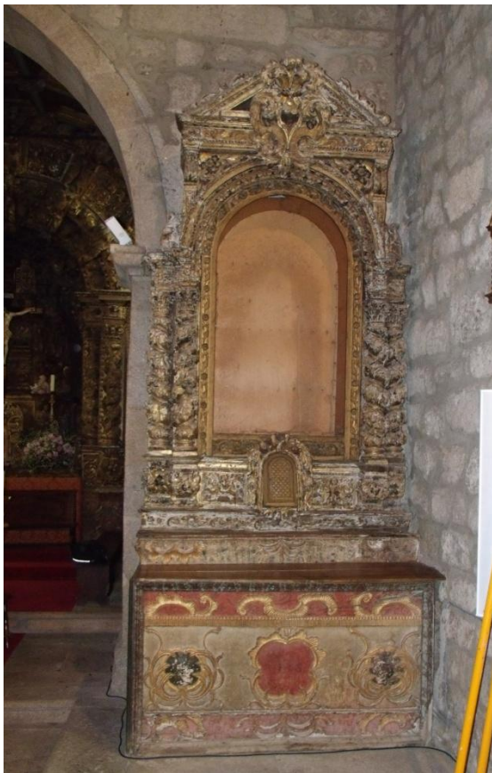
Fig. 166 Retábulo colateral do lado da Epístola antes da intervenção.
