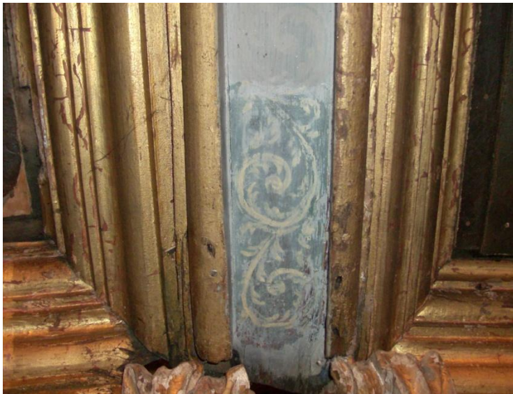
Fig. 180 Levantamento do repinte dos frisos entre as molduras dos caixotões.
