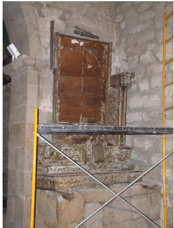
Fig. 111 Estrutura metálica para desmontagem dos retábulos, neste caso, o do lado da Epístola.
