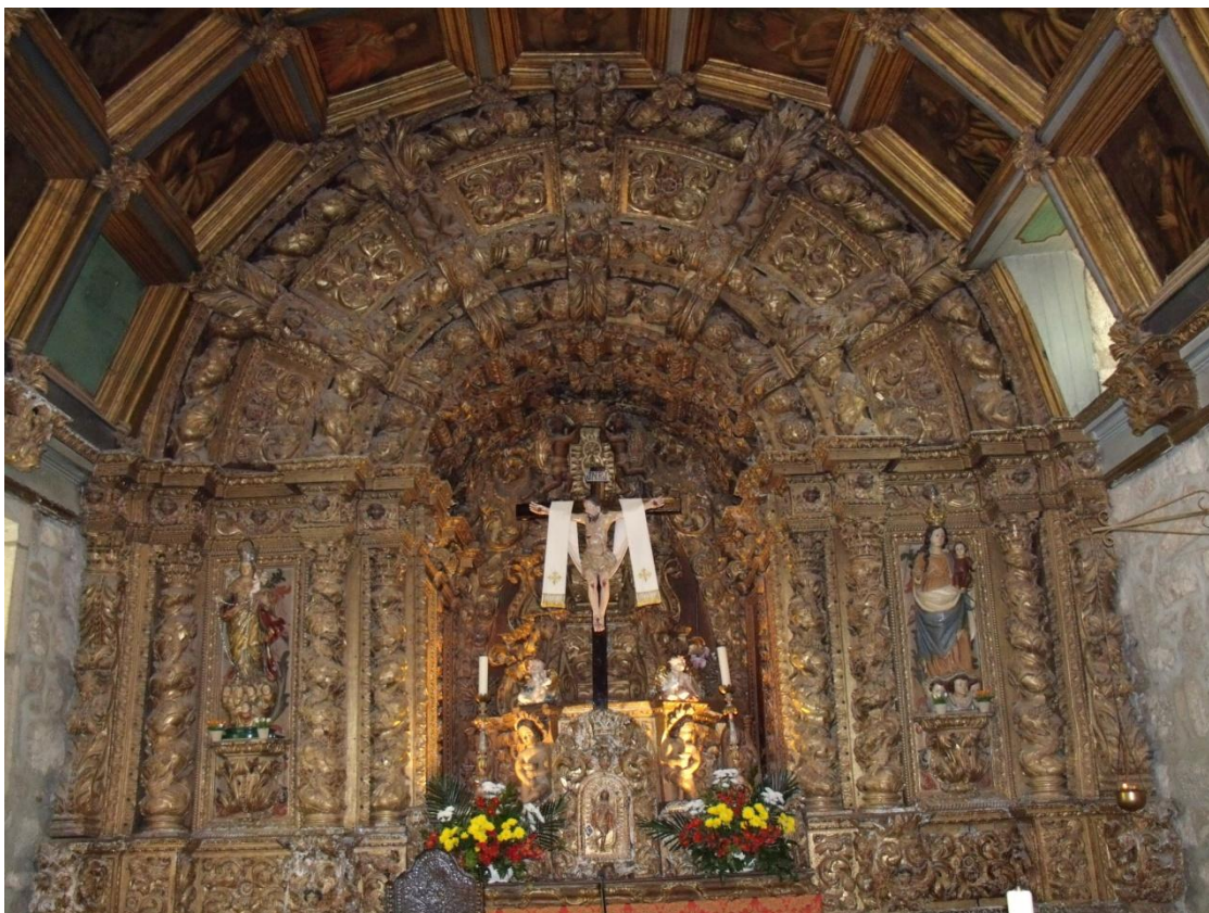
Fig. 29 Aspecto geral do retábulo-mor antes da intervenção.
