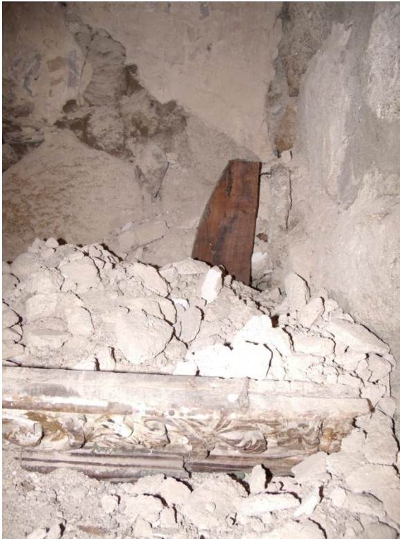
Fig. 110 Parte do entulho presente atrás dos retábulos.
