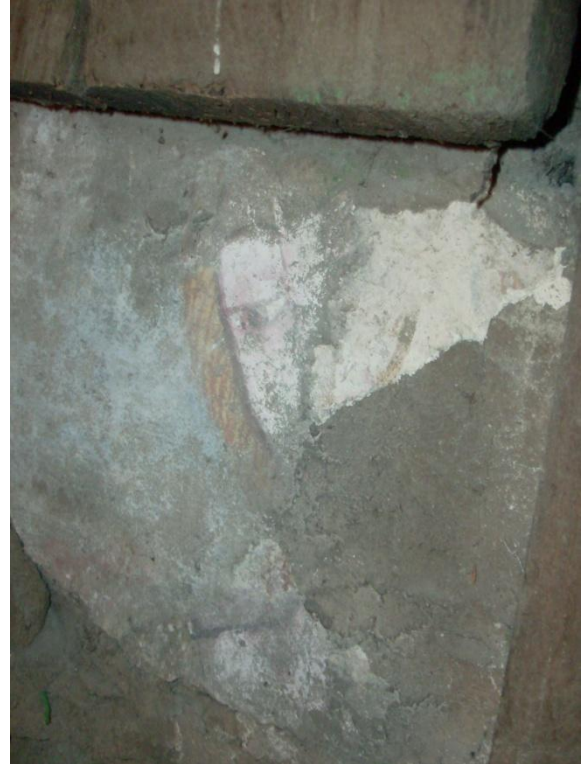
Fig. 50 Vestígios da pintura mural da parede fundeira do retábulo-mor.
