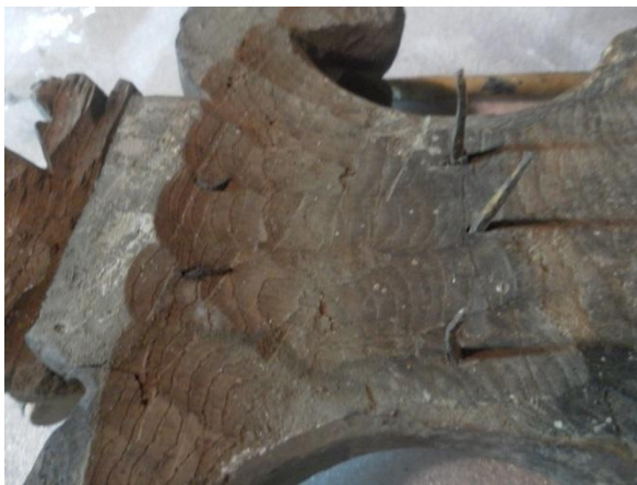
Fig. 87 Oxidação de elementos metálicos (brasão do remate).
