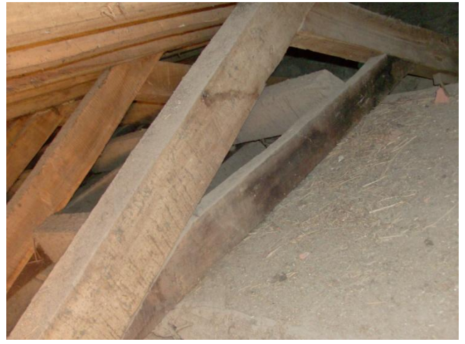
Fig. 98 Acumulação de sujidade por cima das pinturas da capela-mor (teto falso).
