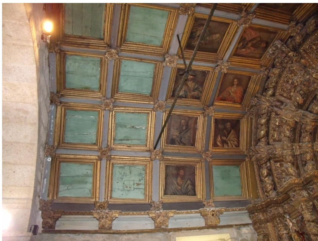
Fig. 44 Teto e sanca do lado do Evangelho (antes da intervenção).
