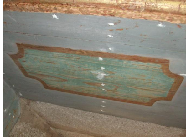
Fig. 183 Abrasão da superfície da pintura por cima da janela.
