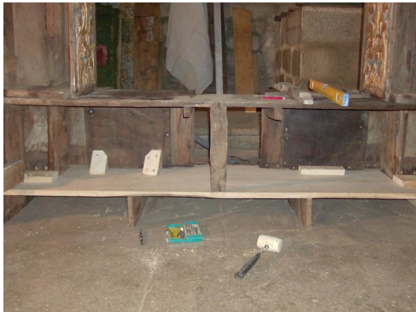
Fig. 131 Reforço estrutural no tardo da predela do retábulo colateral do lado do Evangelho.
