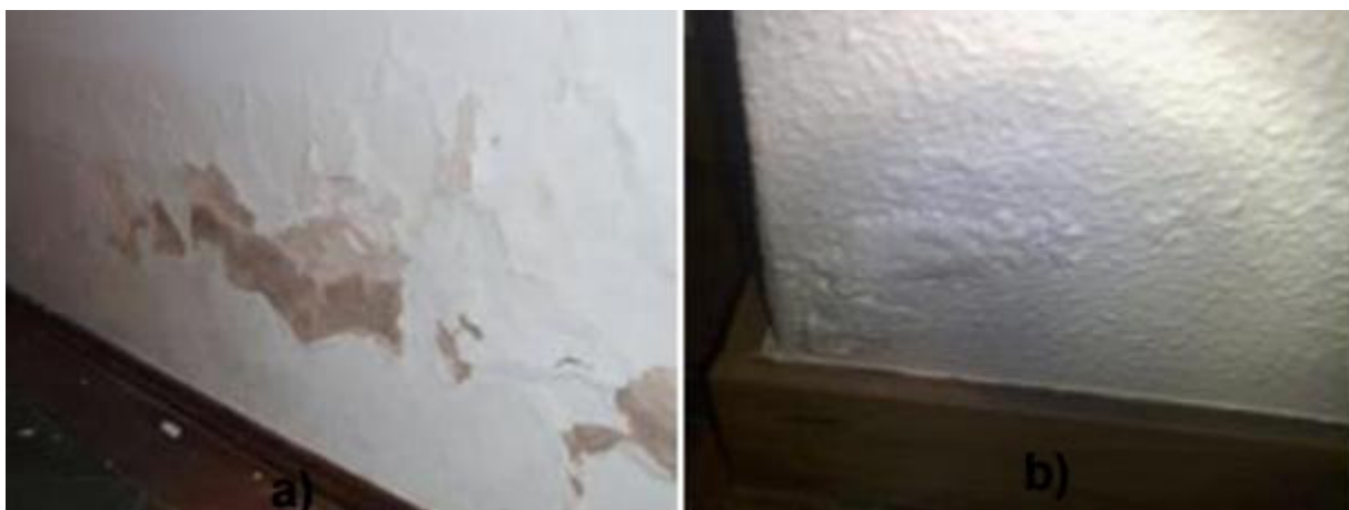
Figura 8 - Anomalias em acabamentos por pintura: a) destacamento; b) empolamento [18]
