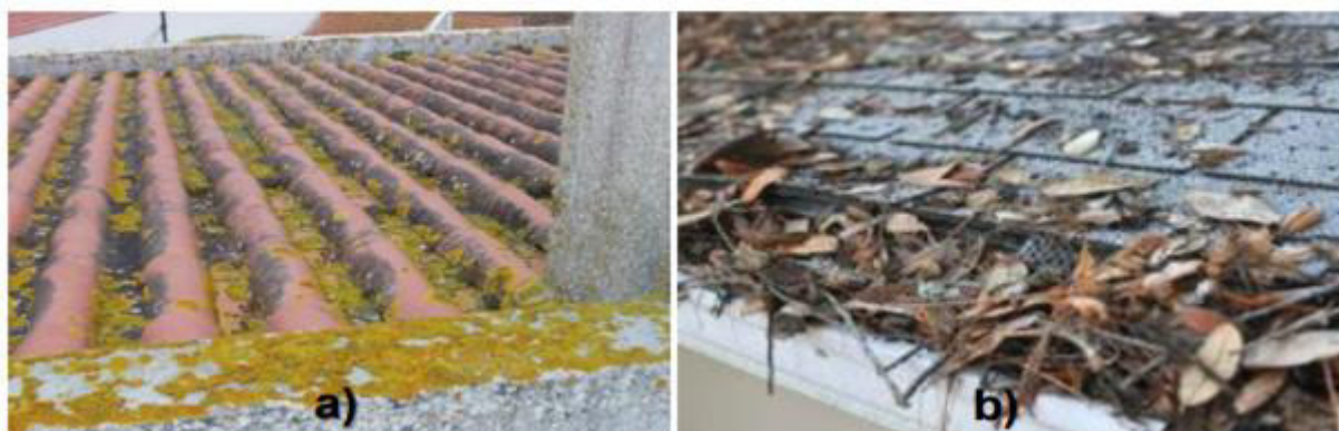
Figura 5 - Anomalias no revestimento em coberturas inclinadas: a) desenvolvimento de colonização biológica; b) acumulação de detritos. [20]
