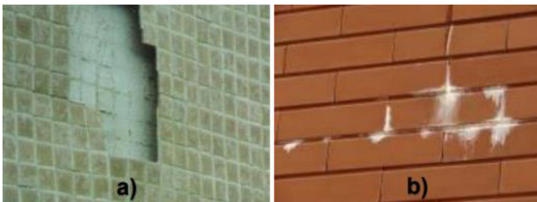
Figura 9 - Anomalias em acabamentos cerâmicos: a) deslocamento; b) eflorescências [23]
