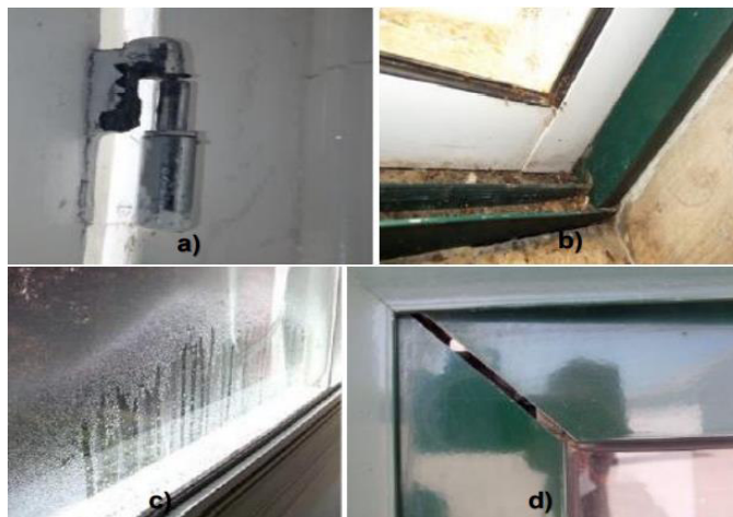
Figura 6 - Anomalias em caixilharias: a) parafuso de fixação danificado; b) acumulação de detritos; c) condensação no interior do vidro; d) juntas abertas/frestas [21]
