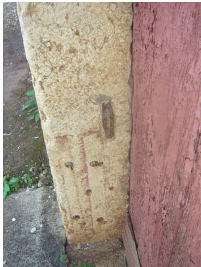
Figura 94: Oxidação de elementos metálicos.
