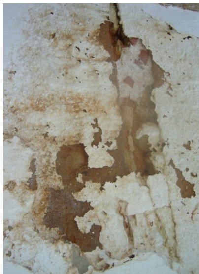
Figura 92: Destacamento do revestimento.
