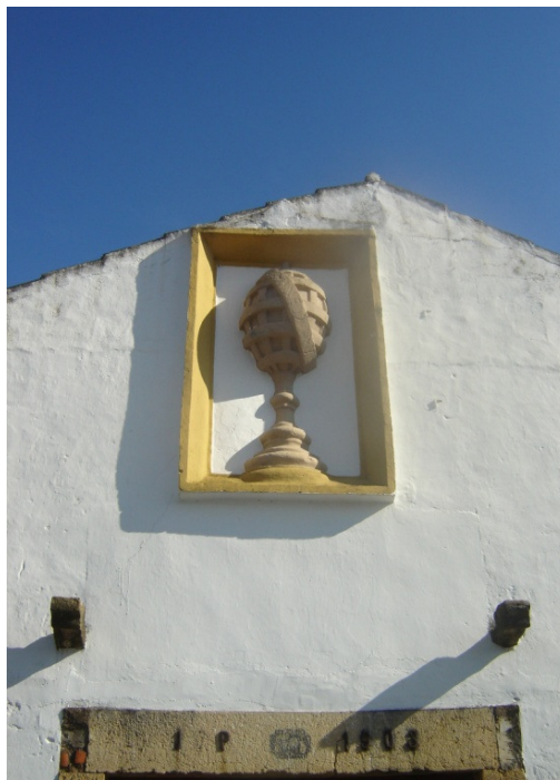
Figura 27 - Descentramento da esfera armilar relativamente a empena do edifício.
