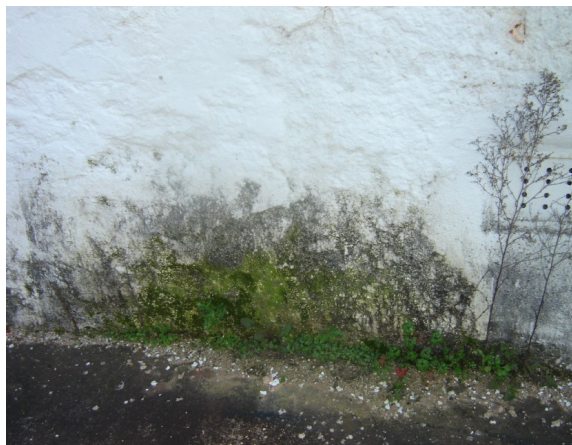
Figura 91: Humidades ascensionais nas alvenarias.
