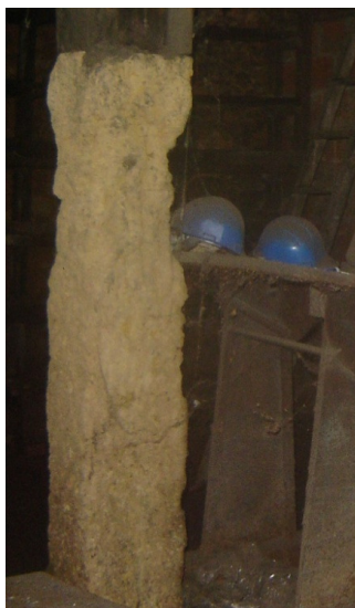
Figura 95: Erosão e perda de secção nos pilares de pedra calcária.
