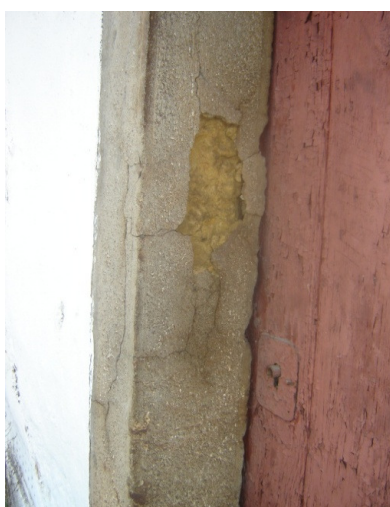
Figura 93: Destacamentos de argamassas de regularização.
