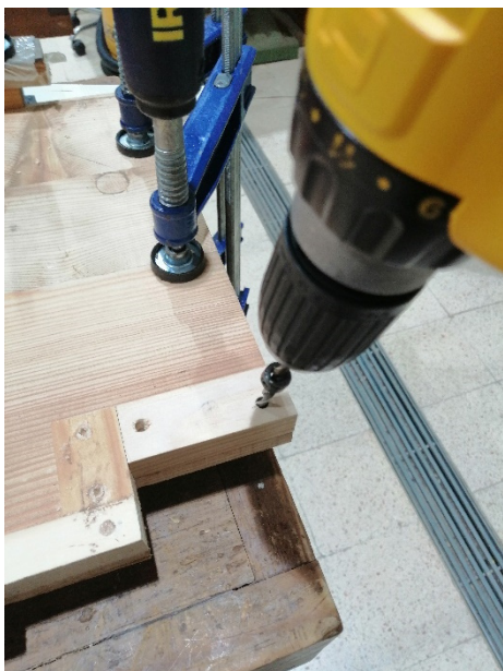
Figura 100- Furação de elemento do friso e da estrutura do fundo para fixação. Fonte: própria
