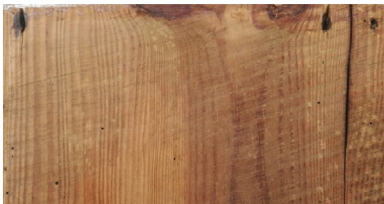
Figura 54- Pormenor de fenda (à esquerda) e fissura (à direita) numa das peças que compõem o fundo do gavetão. Fonte: Maria Folgado
