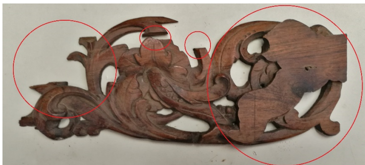
Figura 70- Lacunas e elementos em falta no friso figurativo do friso do entablamento do armário. Fonte: própria
