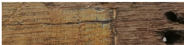
Figura 53- Pormenor de fenda numa das ilhargas laterais. Fonte: própria
