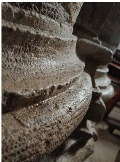
Figura 40. Vestígios de escorrimentos numa das colunas do corpo principal da Igreja Matriz da Golegã. Fonte: própria
