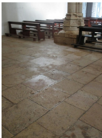
Figura 39- Zonas de acumulação de água no chão da Igreja Matriz da Golegã. Fonte: própria
