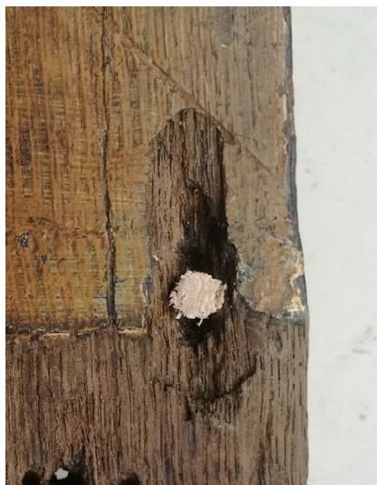
Figura 77- Reenchimento de orifício do prego com cavilha de madeira de faia vaporizada. Fonte: própria
