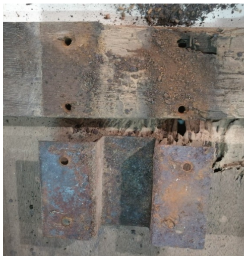
Figura 60- Pormenor da corrosão encontrada na zona inferior da ilharga descartada do armário após a remoção da cantoneira em chapa de aço macio. Fonte: própria
