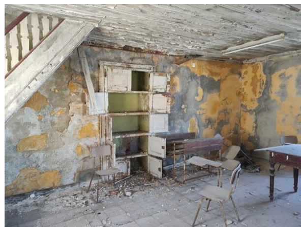
Figura 59 – Paredes Interiores - Incêndio Fachada Poente Fonte: Autor
