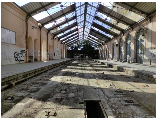
Figura 80 – Cobertura com falta de material Gare Fonte: Autor
