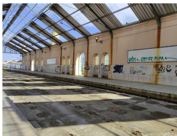
Figura 81 – Paredes vandalizadas Gare Fonte: Autor
