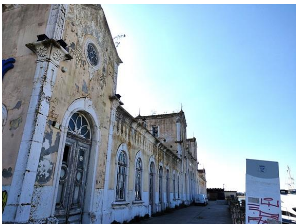
Figura 74 – Parede Exterior – Infiltrações Fachada Poente Fonte: Autor
