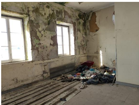
Figura 58 – Paredes Interiores – Infiltrações Fachada Poente Fonte: Autor
