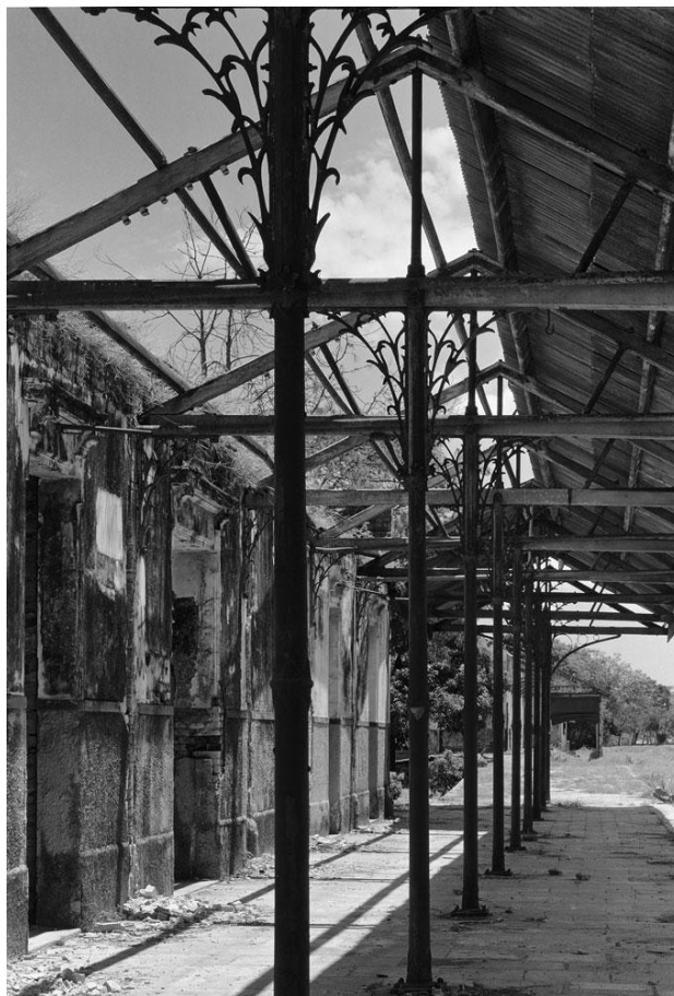
Figura 128 – Estação Ferroviária de Araras Instalações abandonadas – Foto 3 Fonte: Nelson Kon – AUM Arquitetos
