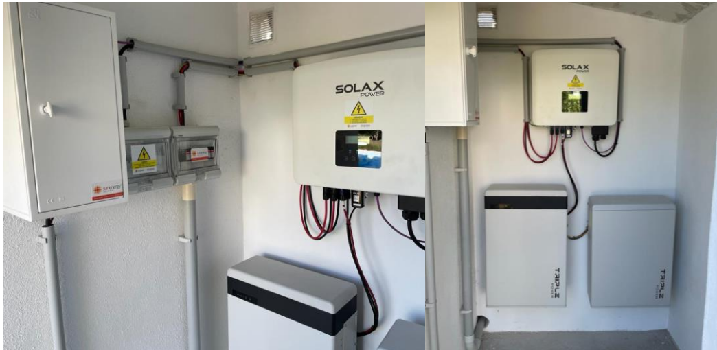
Figura 6.32 – Fotos da zona técnica. À esquerda os quadros de proteção AC e DC e à direita a instalação do inversor e baterias.
