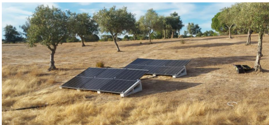
Figura 6.47 - Módulos Fotovoltaicos em Estrutura Solar Bloc no local.
