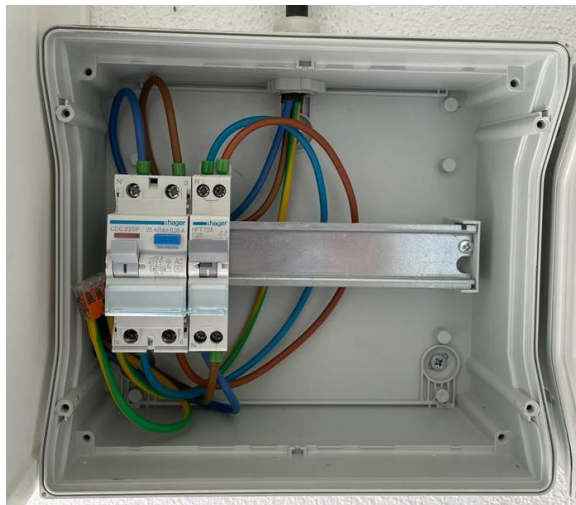
Figura 6.33 - Quadro de proteções AC, sem máscara.
