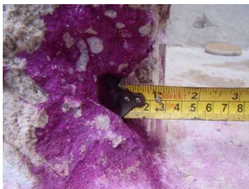
Figura 50 – Carbonatação do betão – Fenolftaleína [22]
