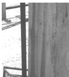
Figura 10 - Mancha de humidade – cofragem [5]
