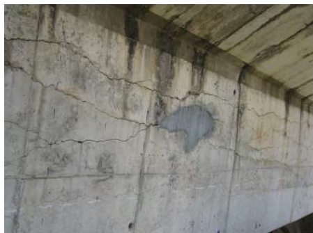
Figura 36 – Fissuração orientada resultante de reações alcalis-sílica e de esforços de compressão [5]
