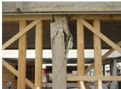
Figura 29 – Fissuras devidas à ação do sismo [13]
