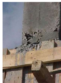
Figura 4 - Vazios no betão - “chochos” [5]
