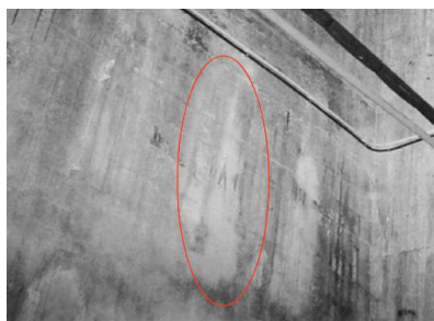
Figura 14 – Descontinuidades visíveis - “esbabaçado” [5]
