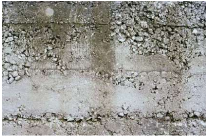
Figura 5 - Acumulação de agregados - “ninhos de pedras” [5]
