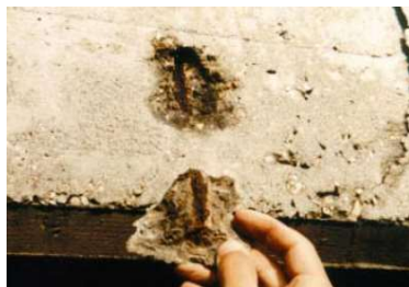
Figura 38 – Desagregação gerada pelo ataque de cloretos [5]
