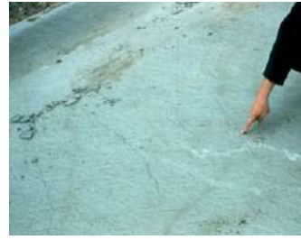
Figura 18 – Fissuras por assentamento plástico do betão [7]
