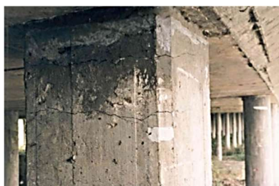
Figura 20 - Fissuração por tração simples [5]
