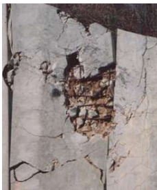
Figura 32 – Zona fragmentada do betão devido a ação de choque (acidente de tráfego) [5]
