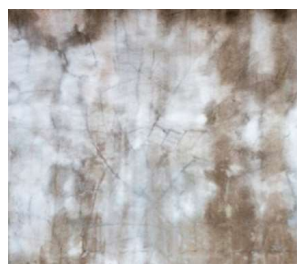
Figura 11 - Mancha de humidade – ascensional [6]
