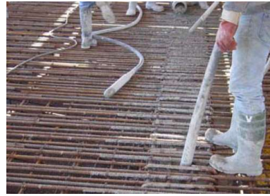
Figura 6 - Espaçamento das armaduras muito pequeno [5]
