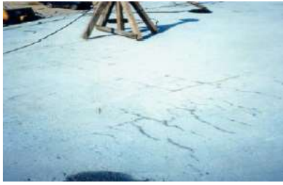
Figura 17 – Fissuras por deficiente cura do betão [7]
