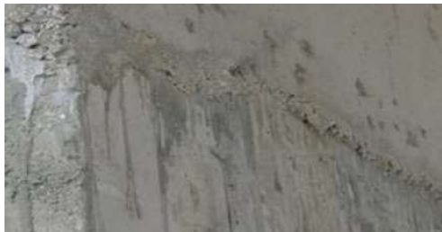
Figura 8 - Descontinuidades visíveis - “esbabaçado” [5]
