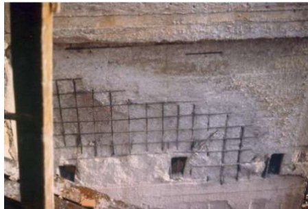
Figura 30 – Parede com destacamento do betão após incêndio [14]
