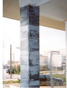
Figura 92 – Mantas aplicadas em pilar [35]
