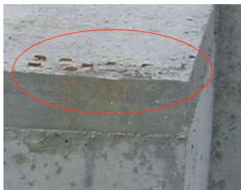
Figura 12 – Deficiente colocação das armaduras [5]
