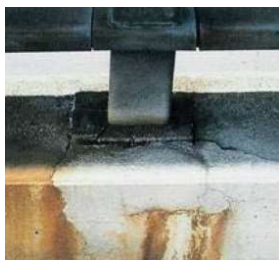
Figura 33 – Manchas de ferrugem [5]
