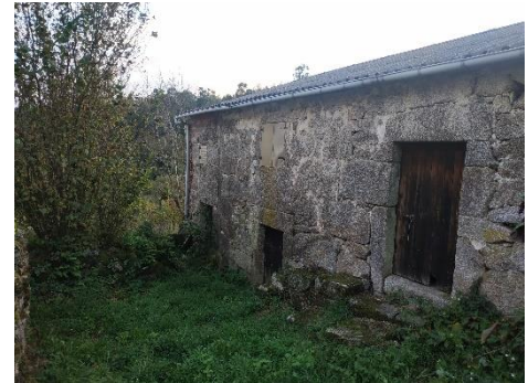
Fig. H13. Ocos na fachada leste.
