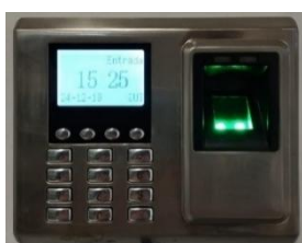
Figura 6 – Terminais de Ponto
