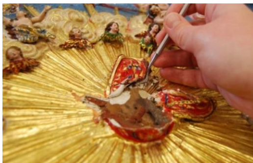
FIG. 173: Preenchimento a nível do suporte de um elemento destacado, após a sua fixação.
