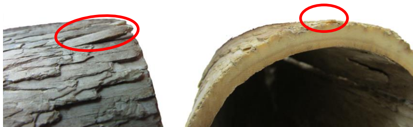
FIG. 100: Elemento em risco de destacamento, antes e após a fixação. (Autoria própria, 2013.)
