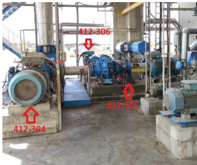
Figura 5.9 - Instalação das bombas de aparas
