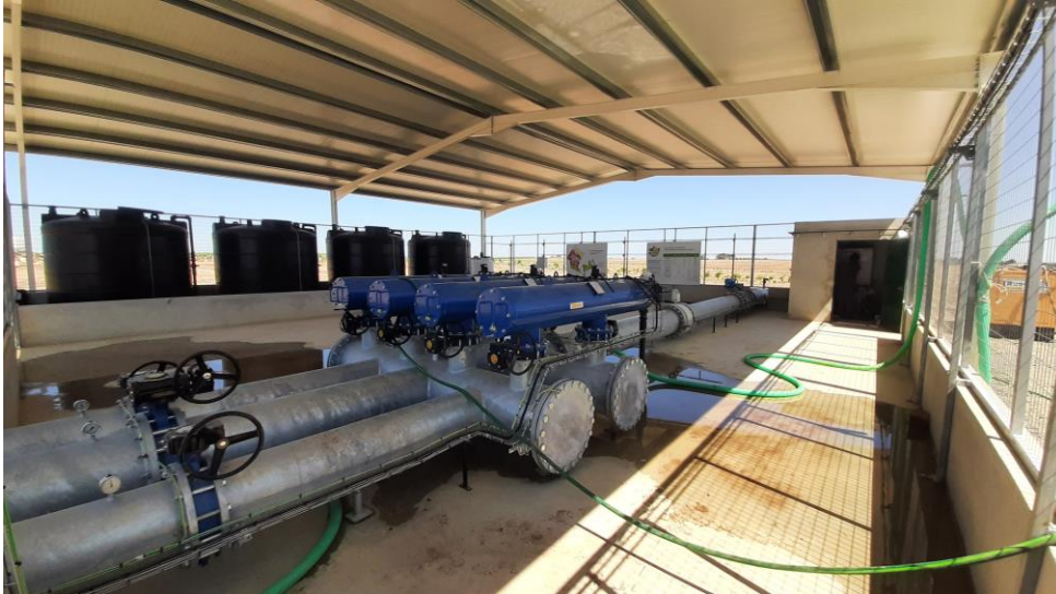
Figura 17 - Casa de rega (filtros, depósitos de adubo e “Agronic”)
