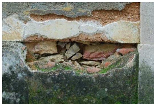
Fig. 5-2: lacunas a diversos níveis das camadas do reboco. Fonte: Autora
