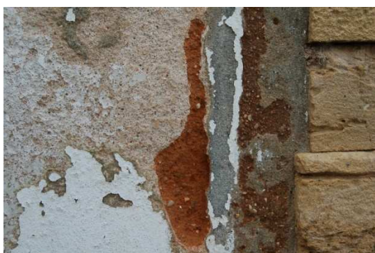
Fig. 5-1: Consequências do preenchimento de lacunas com cimento Fonte: Autora
