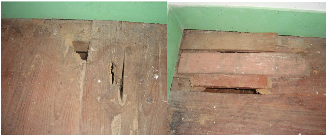
Figura 22 - Pavimento apresenta roturas
