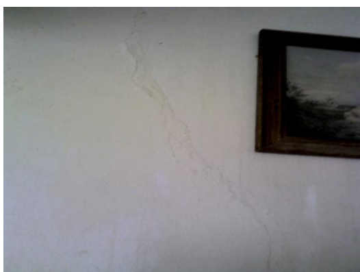
Figura 78 - Fissura numa parede do 2.º andar
