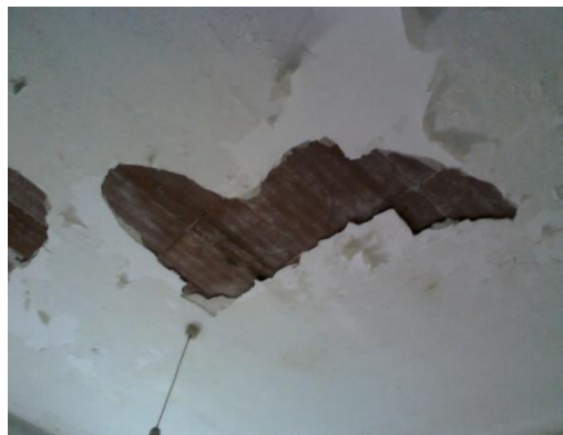
Figura 74 - Humidades no teto do 2.º andar
