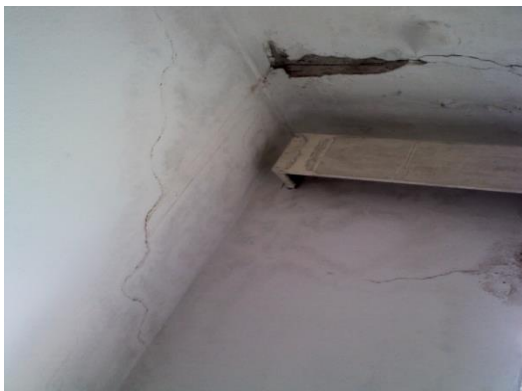
Figura 70 - Parede e teto de um quarto 2.º andar (fissuras)
