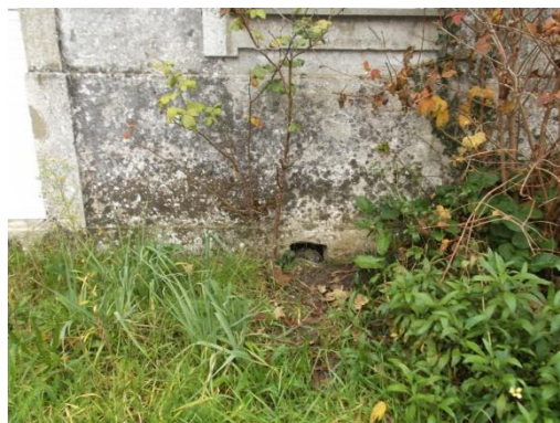
Figura 47 - Abertura (junto ao solo) que serve de ventilador
