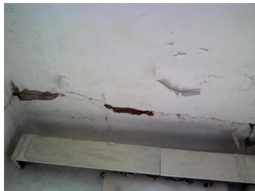
Figura 73 - Teto de um quarto do 2.º andar (fissura paralela à fachada principal)
