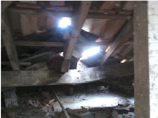
Figura 94 - Sótão (telhas em falta)
