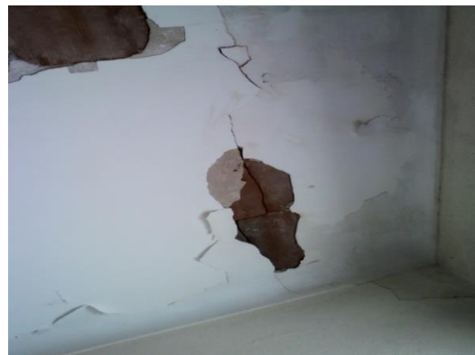
Figura 99 - Fissuras no teto de um quarto do 2.º andar
