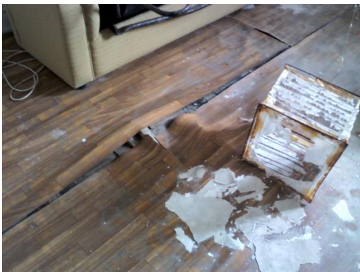
Figura 96 - Piso de uma sala do 2.º andar (humidades)
