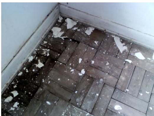
Figura 71 - Humidades no piso do 2.º andar
