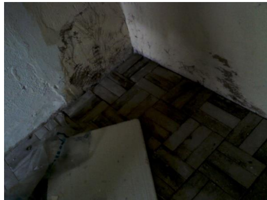
Figura 98 - Humidades no piso do 2.º andar
