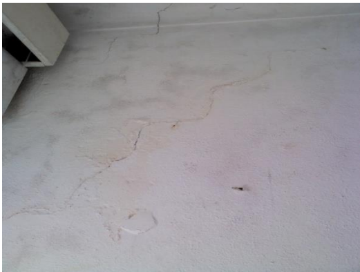
Figura 95 - Parede de um quarto do 2.º andar (fissura “paralela” à fachada)
