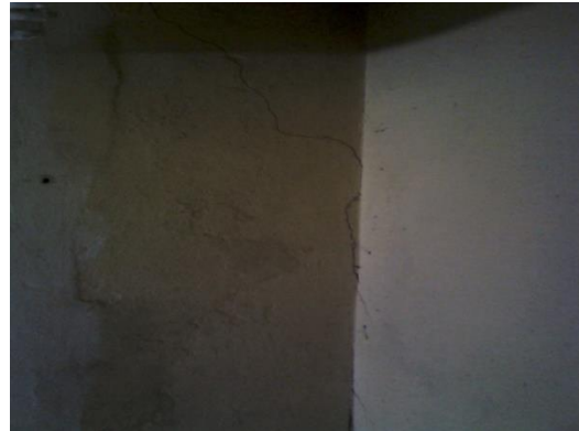
Figura 97 - Fissuras em parede interior do 2.º andar
