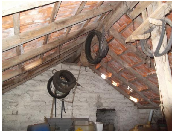
Figura 29 - Elevadas deformações e manchas de humidades
