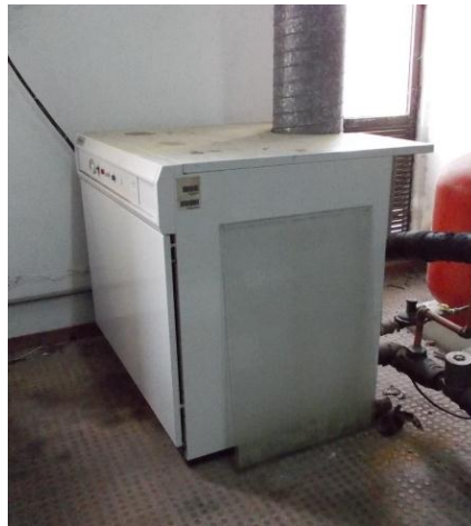
Figura10. Caldeira de aquecimento de água.
