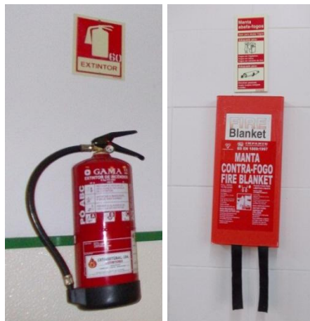
Figura 14. Extintor portátil e manta de incêndio.
