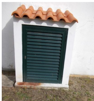
Figura 7. Sistema de gás do bloco F da EST.
