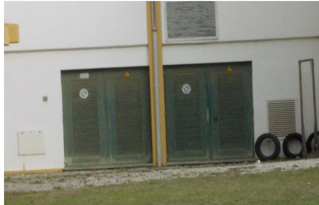
Figura 3. Posto de Transformação da EST.
