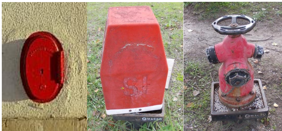
Figura 16. Bocas-de-incêndio de parede e hidrantes de coluna.
