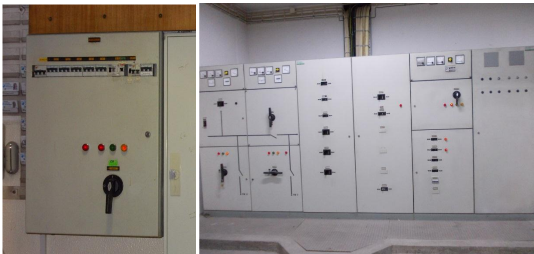
Figura 4. Quadro geral da EST situado na recepção e no posto de transformação, respectivamente.
