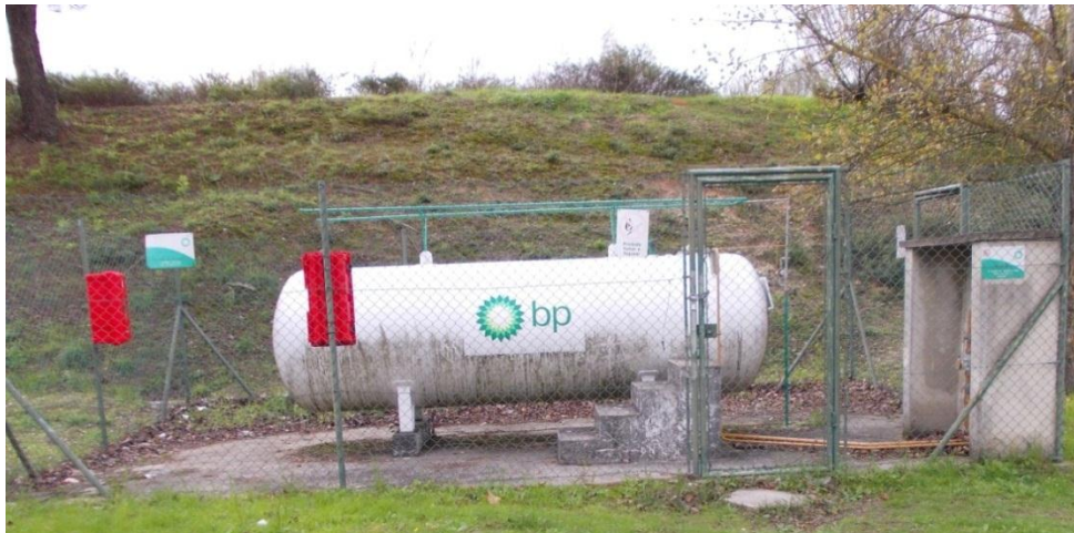
Figura 6. Instalações da rede de gás da EST.
