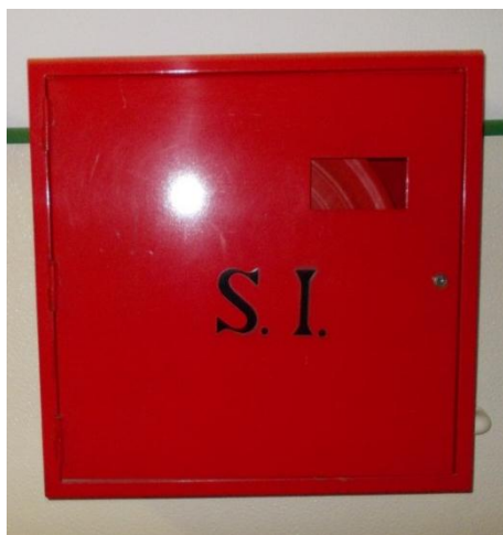
Figura 15. Carretel de incêndio.
