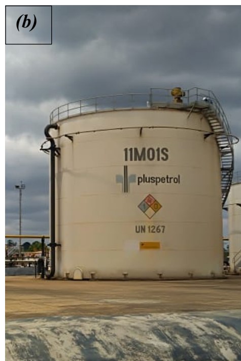
Figura A3 - TK-002; Tanque de armazenamento de petróleo crude .
