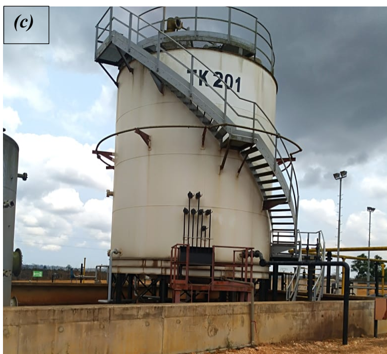
Figura A4 - TK-201; Tanque de resíduos.
