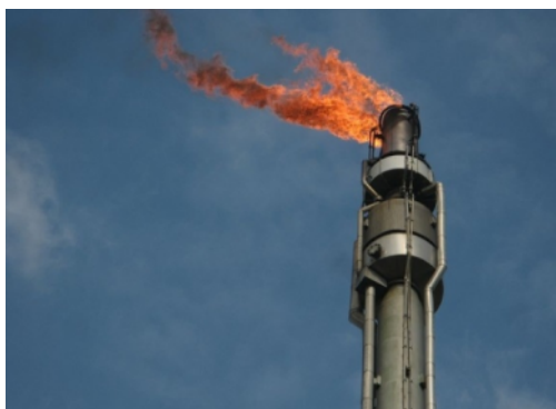
Figura 5.1. Tocha Queimadora de gás [Transeletron, 2017].
