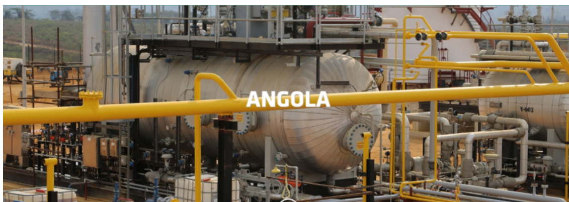
Figura 1.2. Equipamentos da Instalação [Pluspetrol, 2015].
