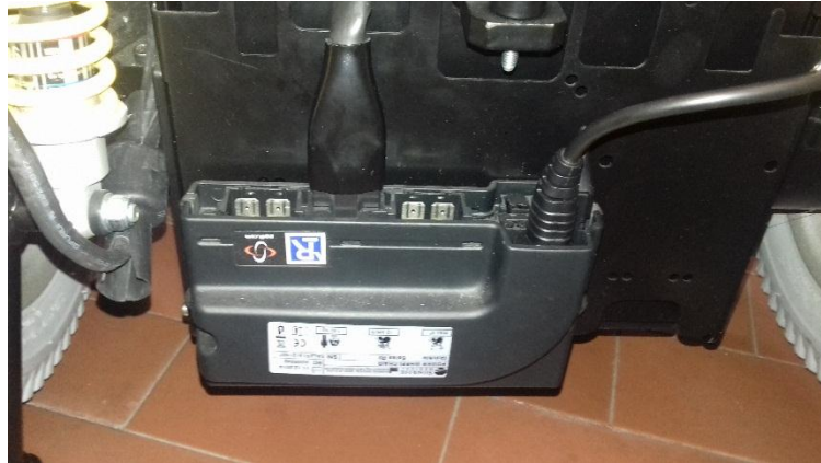
Figura 53- Ficha para carregamento de baterias
