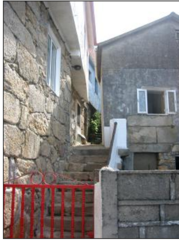
Fig. 135. Casa-vivenda Nº12, fachada onde se localiza a porta de acceso a vivenda.
