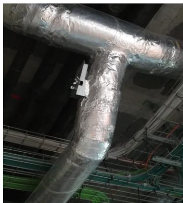
Figura 28 - Registo de caudal manual instalado numa conduta isolada – Obra Palmares
