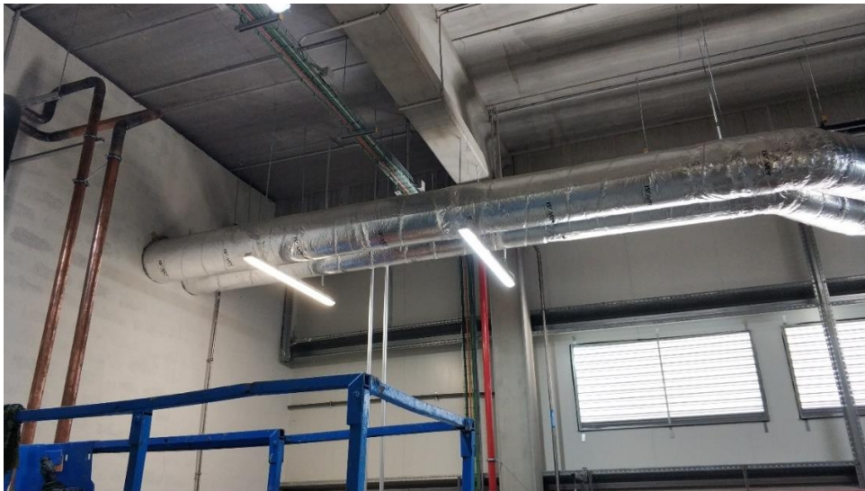
Figura 13 - Conduta Isolada – Obra Driscoll's
