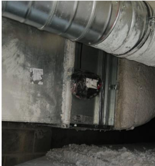
Figura 18 – Registo Corta Fogo instalado – Obra Palmares
