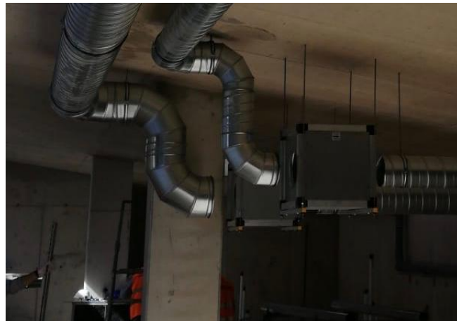
Figura 37 - Ventiladores instalados na central técnica – Obra Palmares
