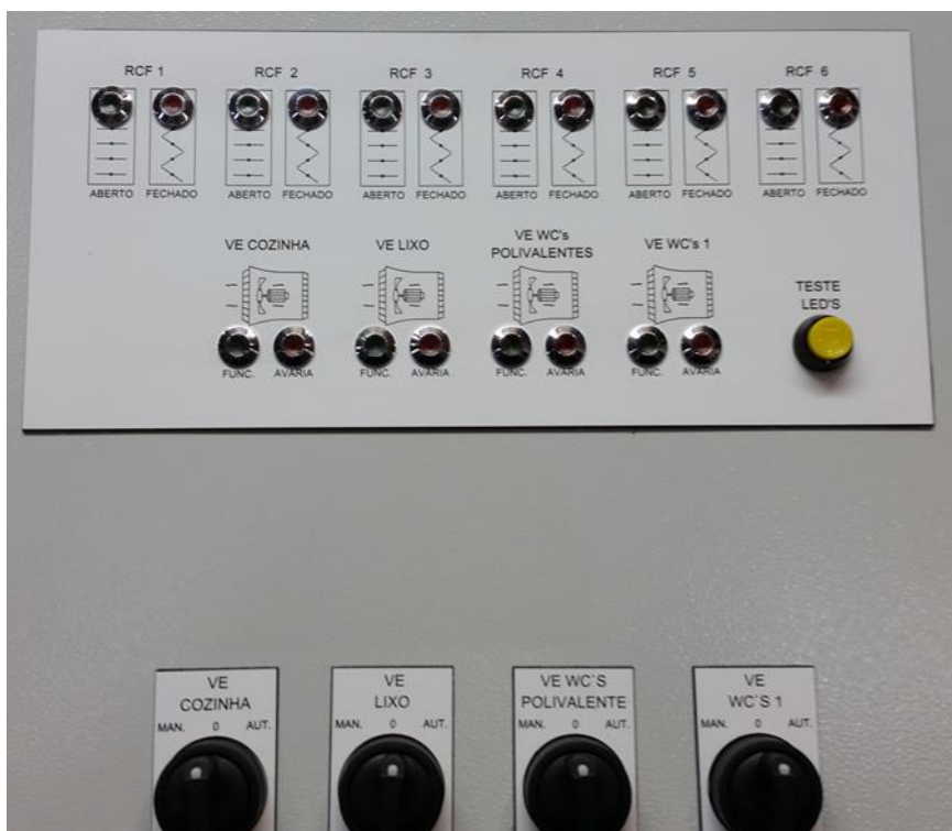
Figura 2 – Representação dos LEDs e comutadores na porta do quadro AVAC.
