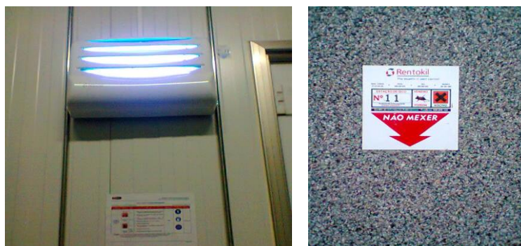
Figura 21 - Electrocaçador do cais de receção de matérias subsidiárias.
