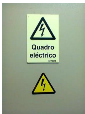
Figura 6 - Sinalização de advertência de perigo em quadro eléctrico.
