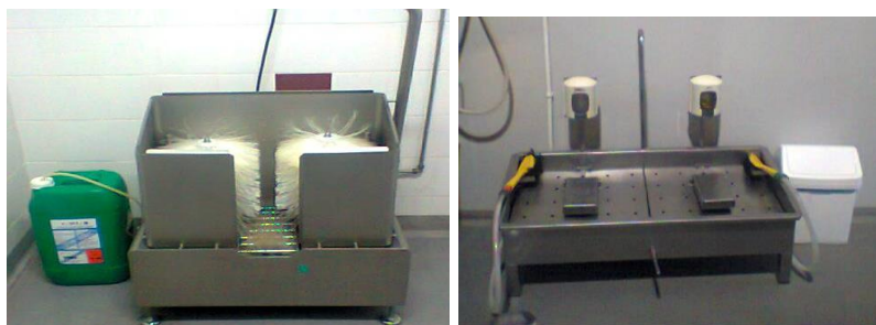
Figura 3 - Equipamentos para lavagem e desinfecção de calçado.
