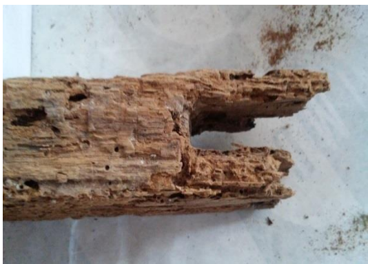
Fig. 81 Elemento do suporte de fixação do painel da tela sem funcionalidade, devida à perda da resistência física e mecânica em consequência da ação dos insetos xilófagos e altos teores de humidade presentes na madeira
