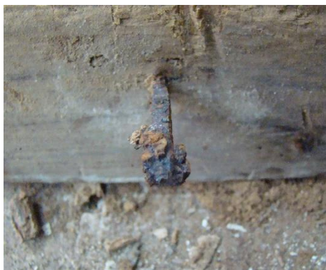
Fig. 36 Elemento metálico antes da remoção com visível corrosão
