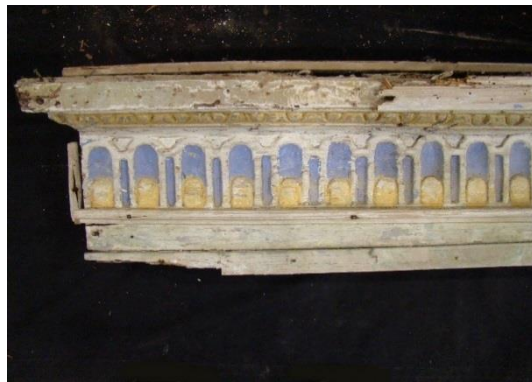
Fig. 58 Entablamento com repintes, perda de volumetria, ação dos insetos xilófagos, superfície pulverulenta
