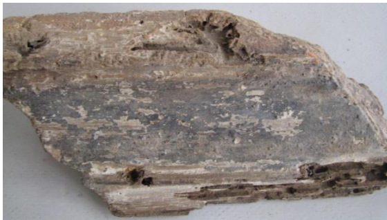
Fig.173 Friso com sujidades superficiais, sem resistência mecânica pela ação de insetos xilófagos e repintado
