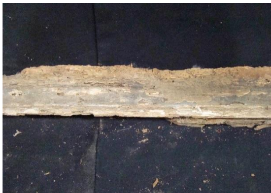
Fig. 75 Friso do entablamento em muito mau estado de conservação. Apresenta podridão cúbica acentuada, sinais evidentes da ação dos insetos xilófagos, e repintes
