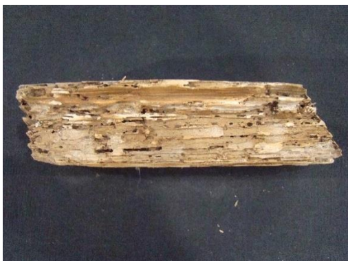
Fig. 28. Ação dos insetos xilófagos num dos elementos do retábulo
