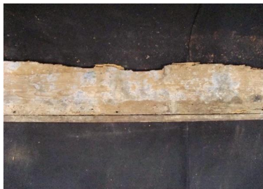
Fig. 64 Elemento do entablamento de madeira utilizada em intervenção anterior
