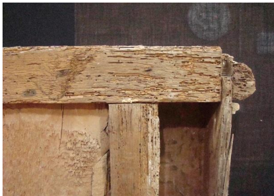
Fig. 57 Pormenor do Verso do painel de fixação da tela. Evidente ação de insetos xilófagos
