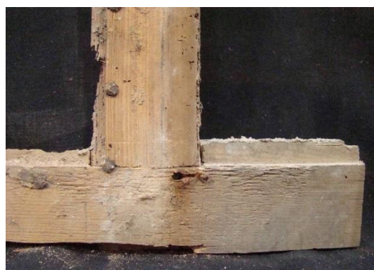
Fig. 68 Elemento estrutural de fixação da tela com poeiras superficiais; elementos metálicos corroídos
