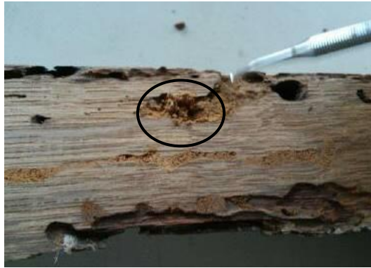
Fig. 37 Pormenor de um corte onde são visíveis as galerias preenchidas por serrim dos insetos sendo perceptível uma insuficiente consolidação pela desagregação do serrim
