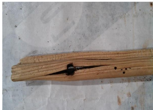
Fig. 76 Friso de intervenção anterior, com evidente deterioração causada pela corrosão dos elementos metálicos, fenda e depósito de corrosão
