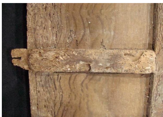
Fig. 47 Pormenor elemento estrutural com evidente ação de insetos xilófagos
