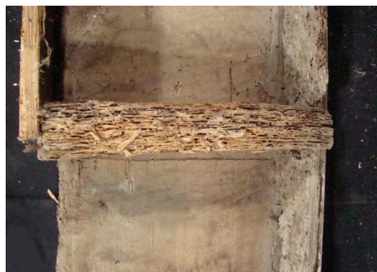
Fig. 56 Elemento de fixação da predela sem funcionalidade devido ao seu mau estado de conservação
