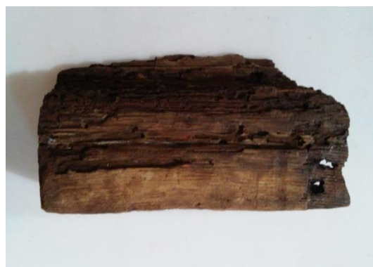
Fig. 80 Friso do entablamento com sinais evidentes de podridão cúbica derivada dos altos teores de humidade presentes na madeira
