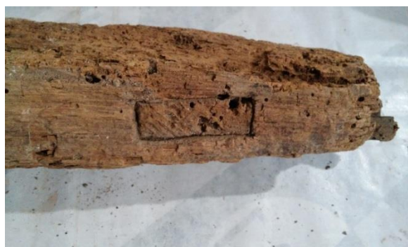
Fig.176 Elemento estrutural deteriorado e sem resistência mecânica por ação de insetos xilófagos e fungos lenhívoros – podridão cúbica
