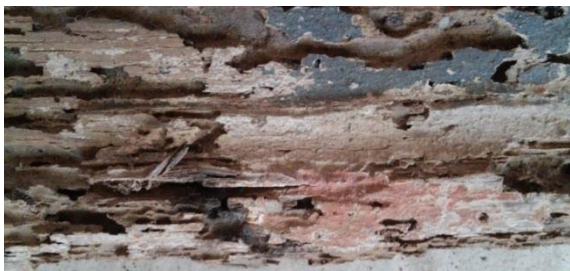
Fig.170 Perda de resistência e funcionalidade de um elemento do retábulo pela ação de insetos xilófagos
