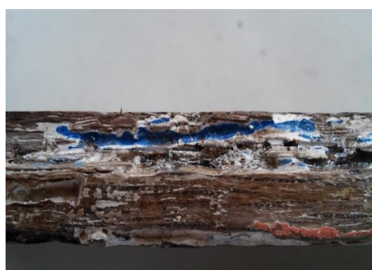
Fig. 74 Elemento do retábulo onde é evidente o repinte sobre a madeira deteriorada pela ação dos insetos xilófagos
