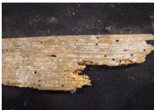
Fig. 65 Pormenor do elemento da fig.21 sem funcionalidade devido ao mau estado de conservação
