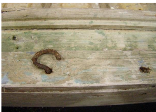
Fif. 59 Pormenor do entablamento com elemento metálico corroído
