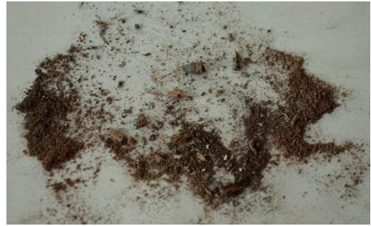
Fig.178 Resíduos de madeira deteriorada pela corrosão
