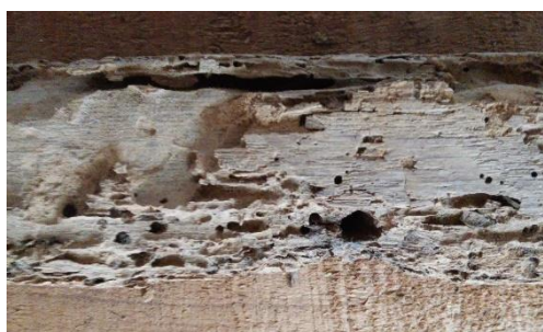
Fig.162 Ação de insetos xilófagos nas madeiras estruturais
