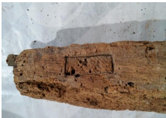
Fig. 77 Elemento do painel de fixação da tela com sinais evidentes de podridão cúbica e ação dos insetos xilófagos, tendo perdido a sua funcionalidade
