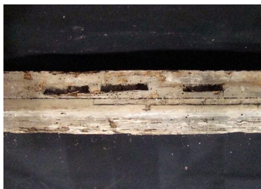
Fig. 50 Pormenor do mau estado de conservação dos encaixes
