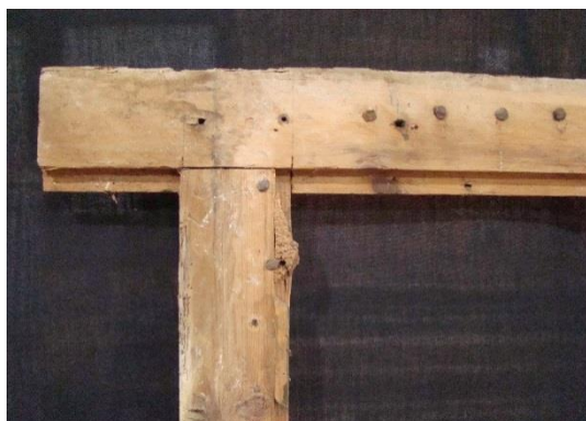
Fig. 69 Elemento estrutural de fixação da tela com elementos metálicos corroídos, poeiras superficiais e manchas de corrosão
