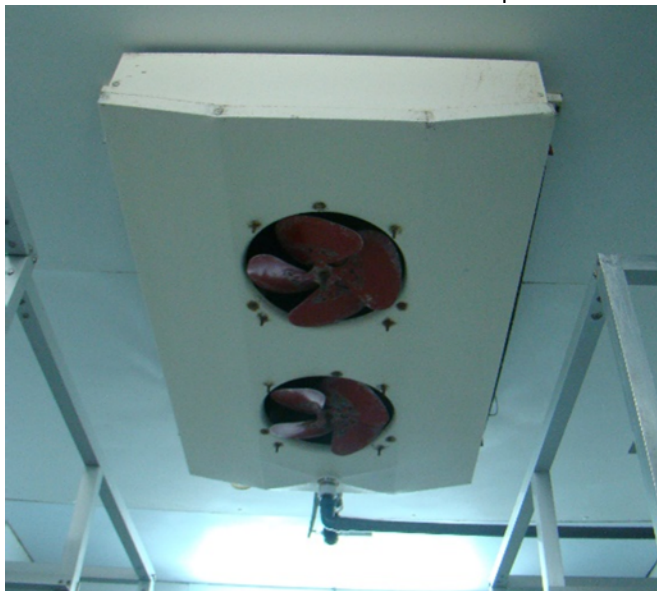
Figura 2.14: Câmara de cura sem condutas e com evaporador central
