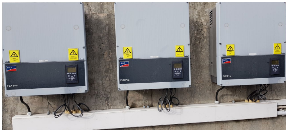
Figura 7.12 – Inversores em funcionamento
