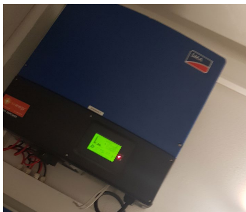
Figura 7.1 – Um dos Inversores do Hotel MH Peniche
