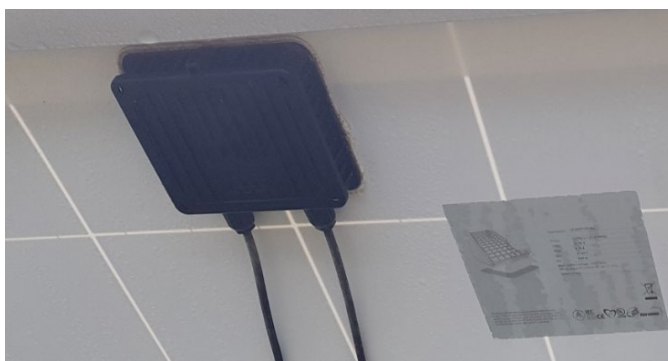
Figura 3.18 - Caixa de junção elétrica de um módulo fotovoltaico
