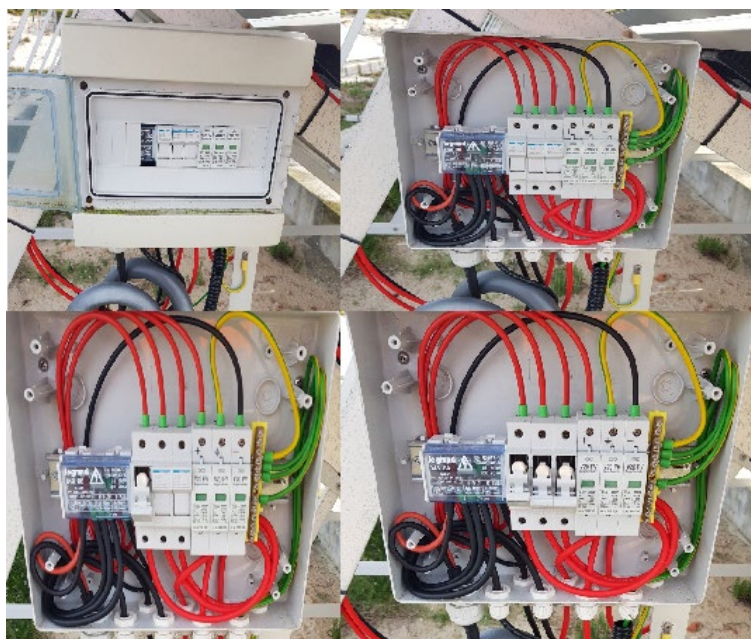
Figura 7.2 – Quadro de corrente contínua (QDC)
