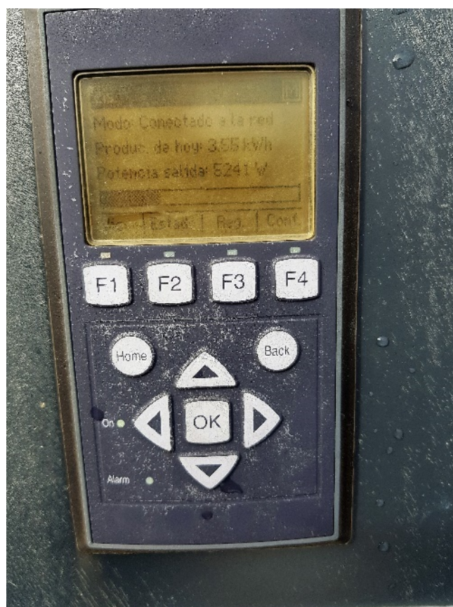
Figura 7.13 – Visor de um dos inversores, onde se mostra que está ligado à rede, quanto está a produzir e qual a potência à saída do inversor.
