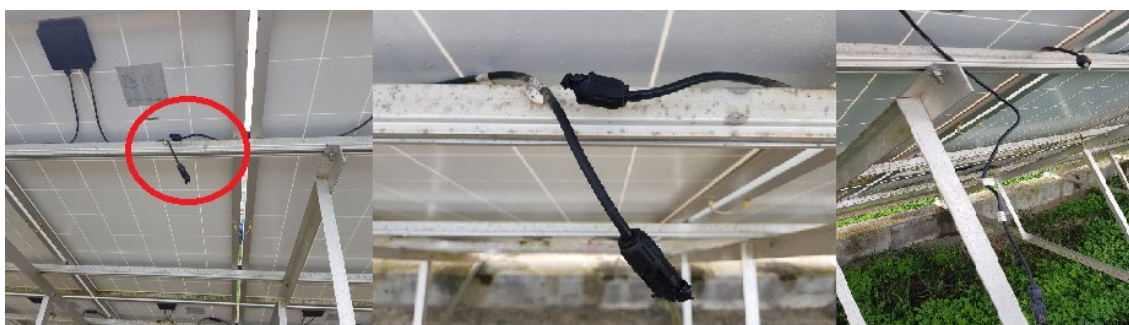
Figura 7.4 – Fichas destruídas devido à forte salinidade presente na área.
