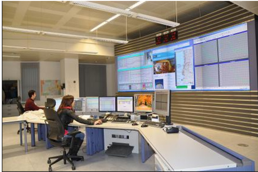
Figura 2. 6 - Centro de controlo com gestão técnica.
