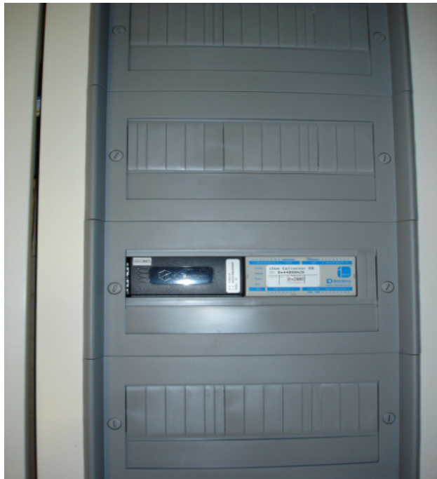
Figura 2. 3 - Quadro elétrico de Aplicação de Domótica.
