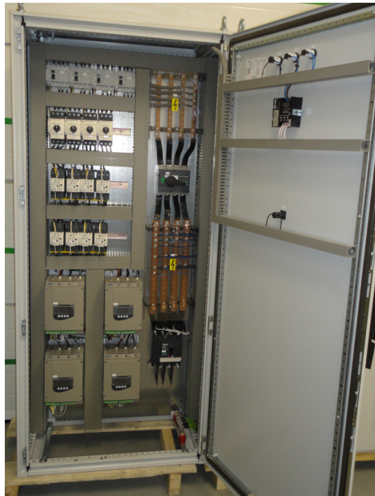
Figura 2. 17 - Quadro de Automação Fabricado pela RC Automação
