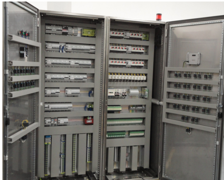
Figura 2. 4 - Quadro elétrico produzido pela RC Automação.
