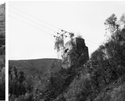
5- POSTO DE TRANSFORMAÇÃO ELETRICA
