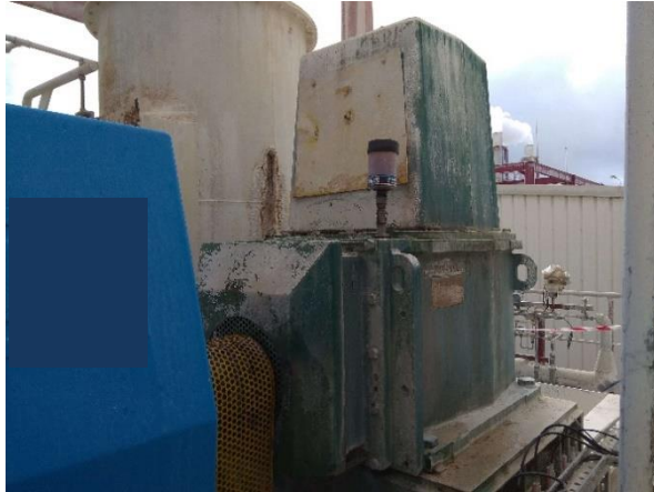
Figura 30 - Inexistência de marcações de pontos de lubrificação
