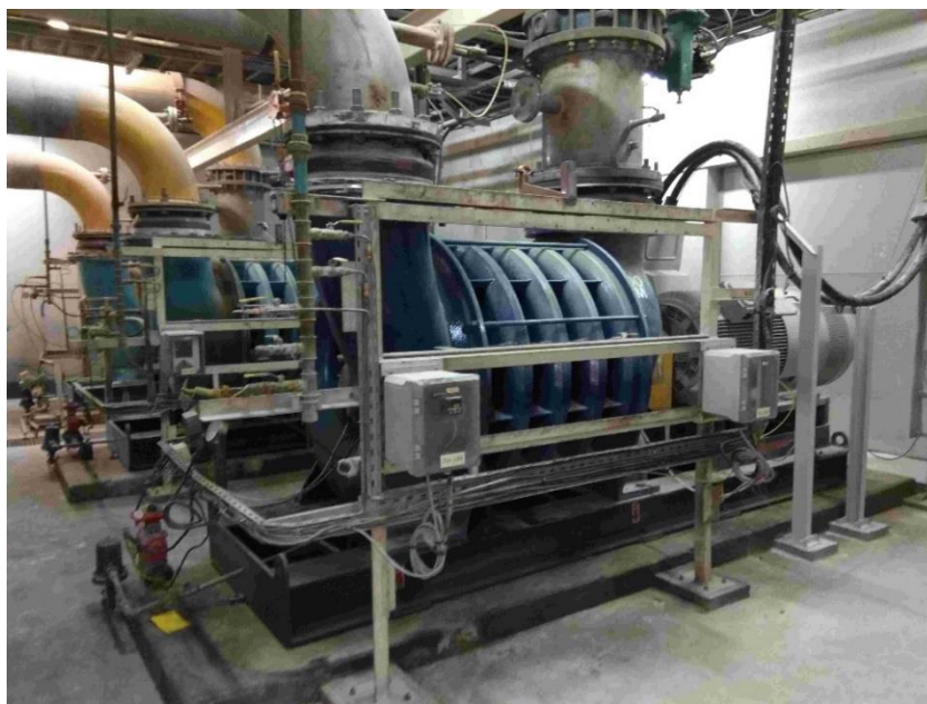
Figura 26 – Compressor de gás de chaminé antes da atividade de manutenção
