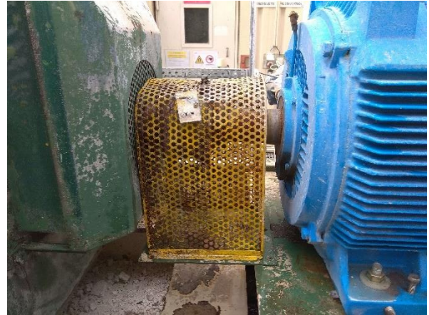
Figura 31 - Proteção de partes móveis não conforme
