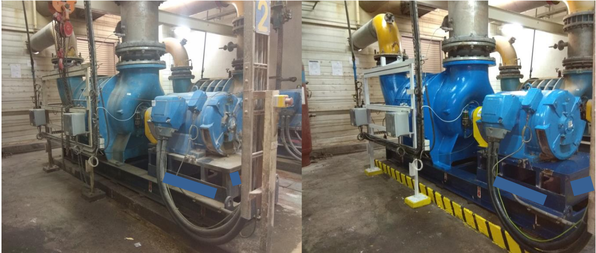
Figura 29 - Comparação do estado do do compressor de gás de chaminé, antes e depois da atividade – vista geral (c)
