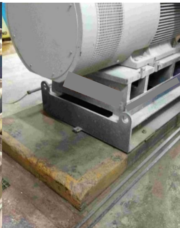
Figura 23 – Base do compressor sem marcações e motor coberto de poeiras
