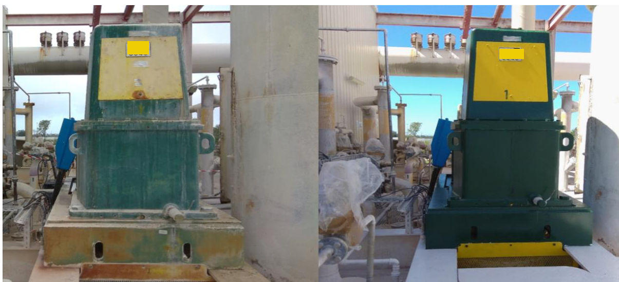
Figura 34 - Comparação do estado do Agitador, antes e depois da atividade - estado geral do equipamento
