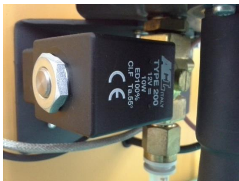
Figura 34- Eletroválvula de drenagem
