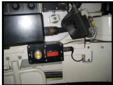
Figura nº 14 - Colocação de um dispositivo de corte do motor na torre do carro de combate.
