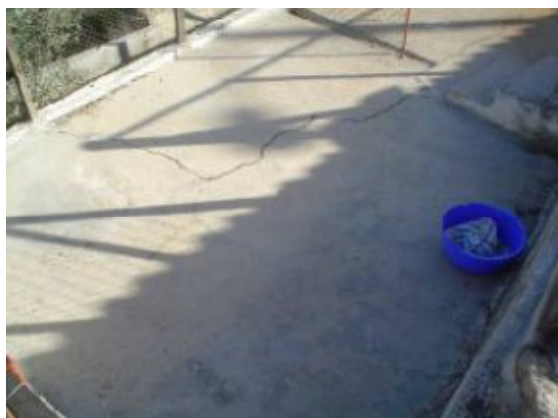
Figura 71 – Fissuração no logradouro. (9)
