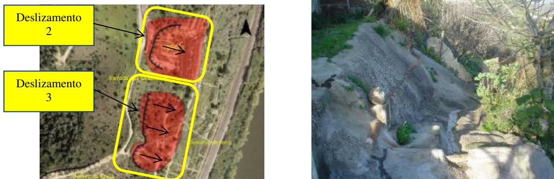
Figura 69 – Localização dos deslizamentos. (9) Figura 70 – Logradouro - Impermeabilização. (9)
