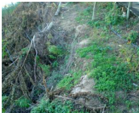
Figura 40 - Escorregamento junto à casa de alcaçova
