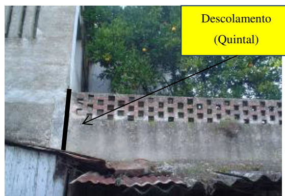
Figura 29 - Fissura no logradouro. (9)
