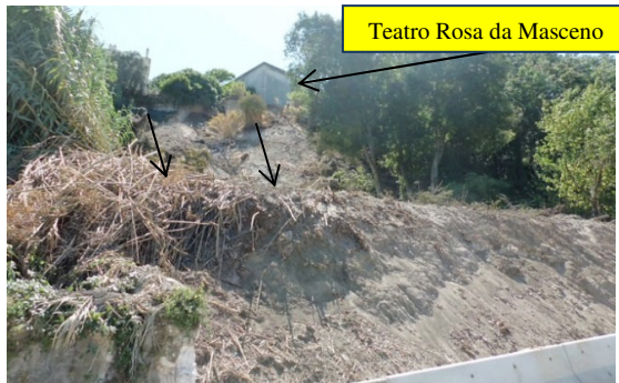
Figura 30 - Vista da encosta, depois do deslizamento
