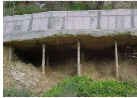
Figura 50 - Descalçamento – Muros contenção. (9)
