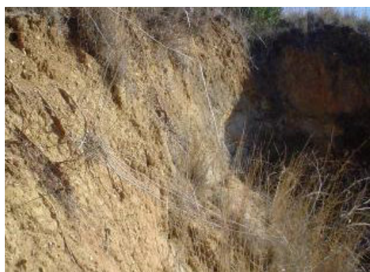
Figura 24 - Pormenor da cicatriz na encosta.
