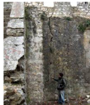
Figura 55 - Fissura na muralha. (9)
