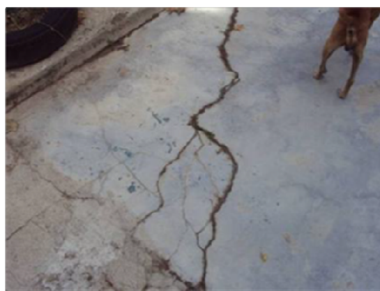
Figura 60 - Fissura no logradouro. (9)
