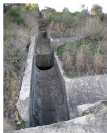
Figura 76 – Valeta de drenagem.
