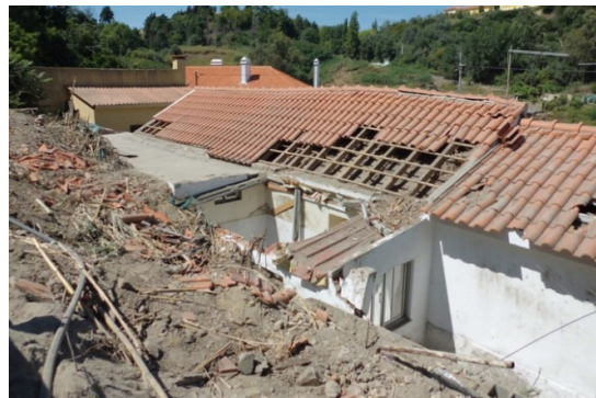
Figura 33 - Habitação soterrada, limpeza de
