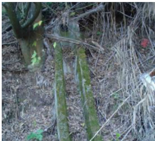
Figura 41 - Valeta de drenagem degradada.
