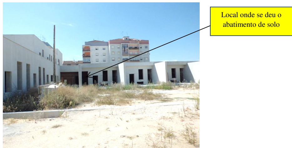
Figura 95 – Alçado Norte – Local onde é mais visível a fissuração.
