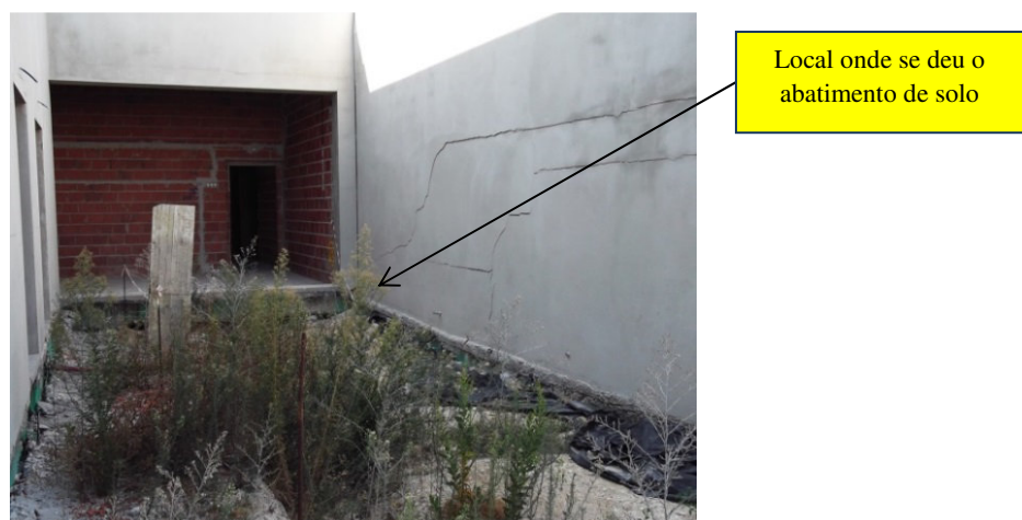
Figura 96 – Alçado Norte – Abatimento do solo – Fissuração generalizada.
