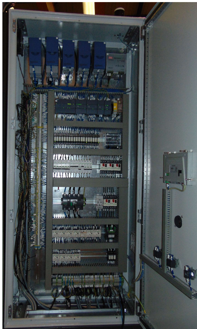
Figura 3.6 – Quadro Elétrico Coluna de Soldadura [24]
