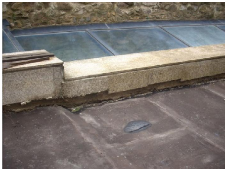
Figura. 109 - Falta de remates / acabamentos
