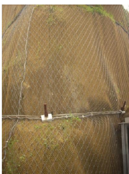
Figura. 115 - Estabilização do muro, aparecimento de vegetação rasteira
