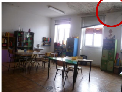
Figura. 130 - Zona onde existe acumulação e escorrência de água
