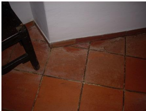
Figura. 88 – Humidade no pavimento térreo
