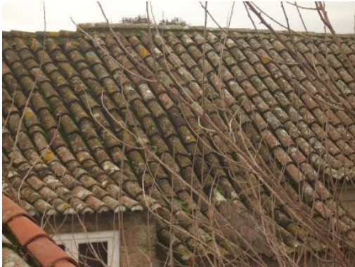
Figura. 91 – Abaulamento do telhado
