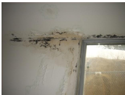
Figura. 119 - Descasque e aparecimento de caruncho na parede e teto junto à janela
