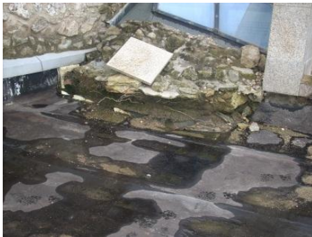
Figura. 107 - Acabamentos mal executados
