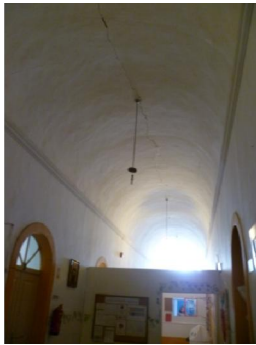
Figura. 133 - Fissuração do teto
