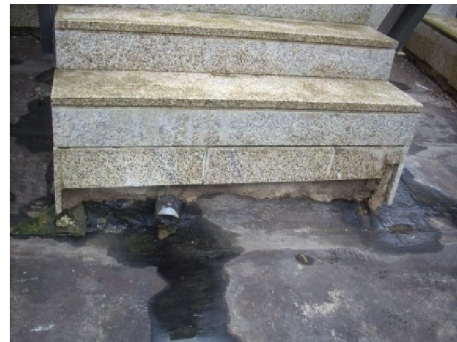
Figura. 110 - Deficiente colocação dos elementos de drenagem e da inclinação da cobertura
