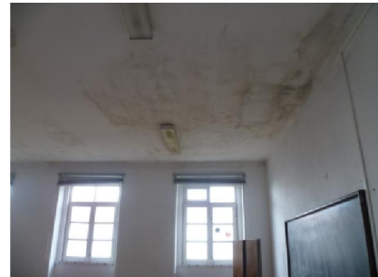
Figura. 129 - Presença de humidade por infiltrações nos tetos
