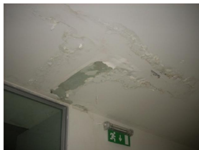
Figura. 118 - Empolamento e descasque da pintura no teto
