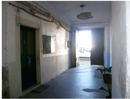
Figura. 134 - Queda de reboco
