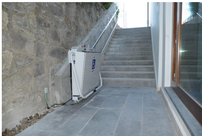
Figura 28 - Exemplo de plataforma elevatória para escadas (Escadafácil Lisboa 2024)
