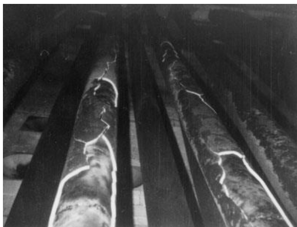
Figura 4.5 - Longa fenda longitudinal típica de falha frágil em fornalha de pirólise, [3].
