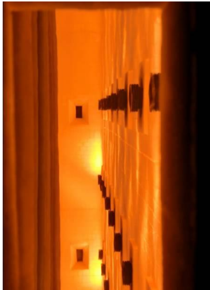
Figura 2.4 - Zona da radiação de uma fornalha de pirólise.
