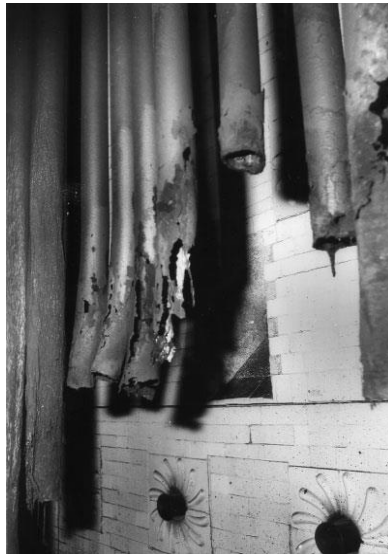
Figura 4.8 - Falha por sobreaquecimento dos tubos da radiação, [3].
