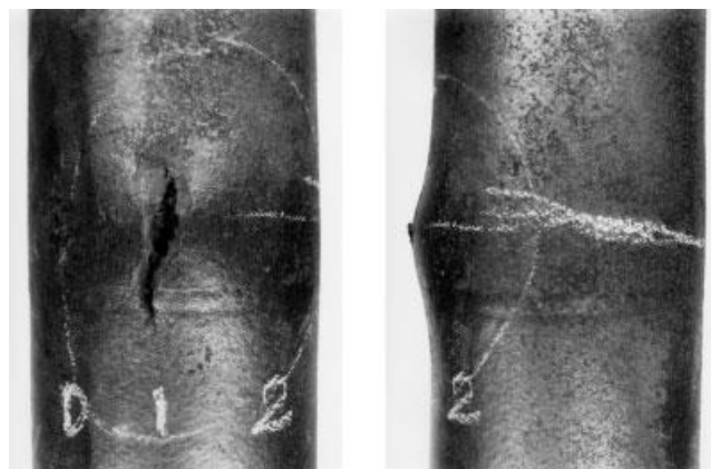
Figura 4.4 - Falha dúctil típica em tubo da radiação de uma fornalha de pirólise, [3].
