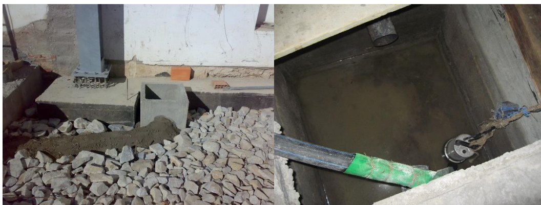
Figura 20 - Infraestruturas de drenagem de águas pluviais
