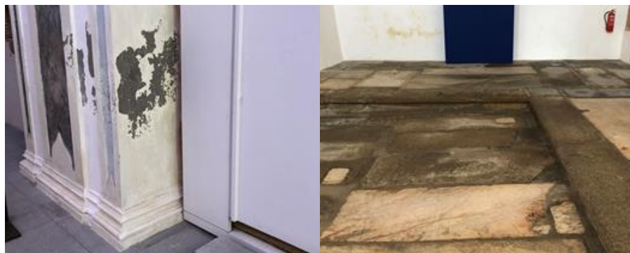
Figura 92 – Humidade nas paredes e pavimento da Igreja
