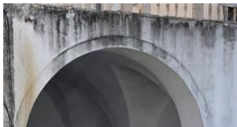
Figura 91 - Escorrências e sujidade na fachada
