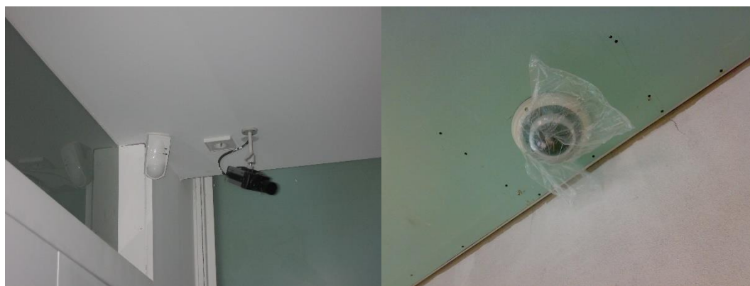
Figura 24 - Infraestruturas de Telecomunicações e Alarmes técnicos
