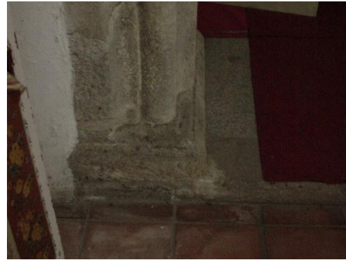
Figura 43 - Vestígios de humidade ascensional
