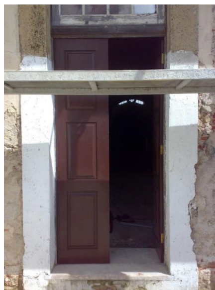
Figura 34 - Vestígios da transformação da janela em porta
