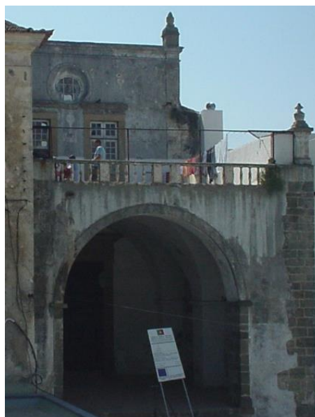
Figura 39 - Sujidade na fachada da igreja
