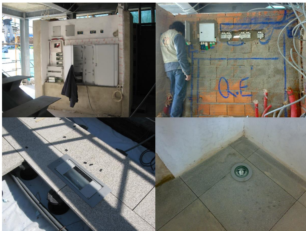
Figura 23 - Infraestruturas elétricas, controlo e design de iluminação
