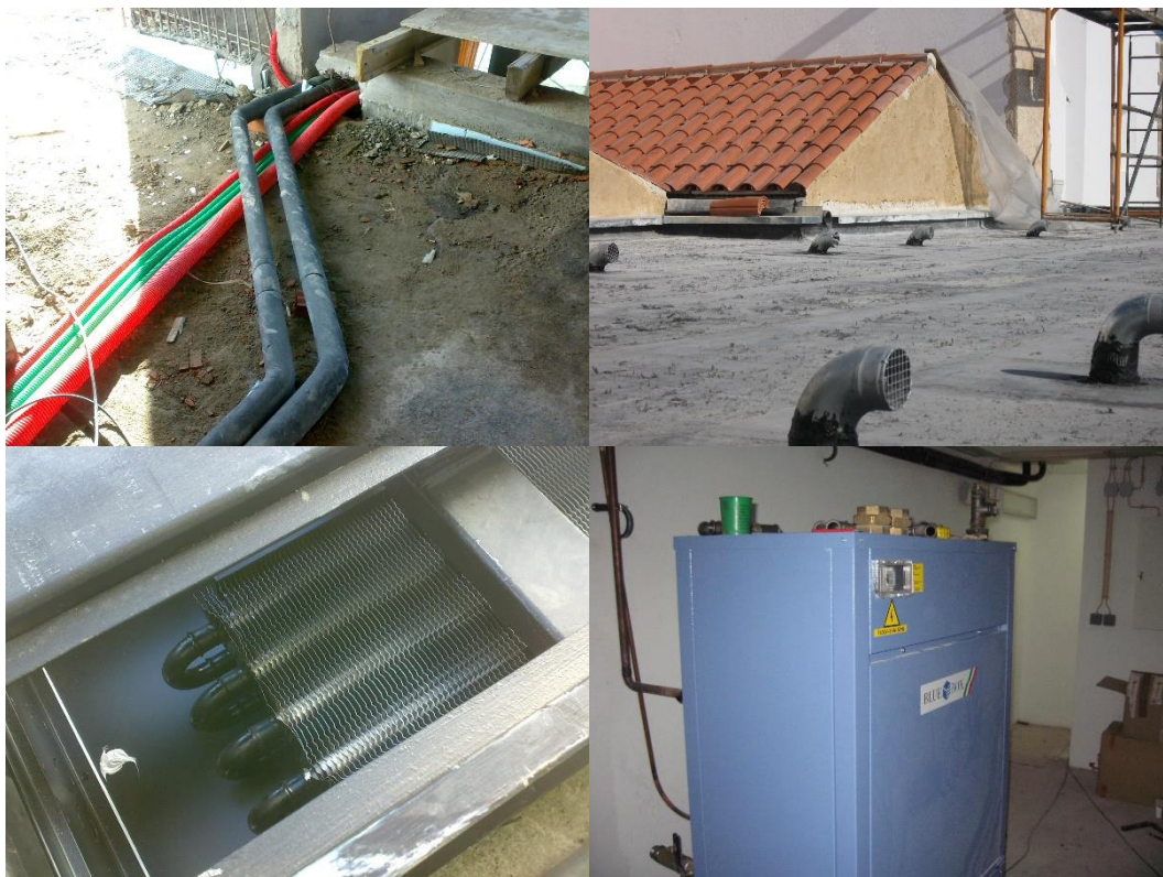
Figura 19 - Infraestruturas e equipamentos de climatização
