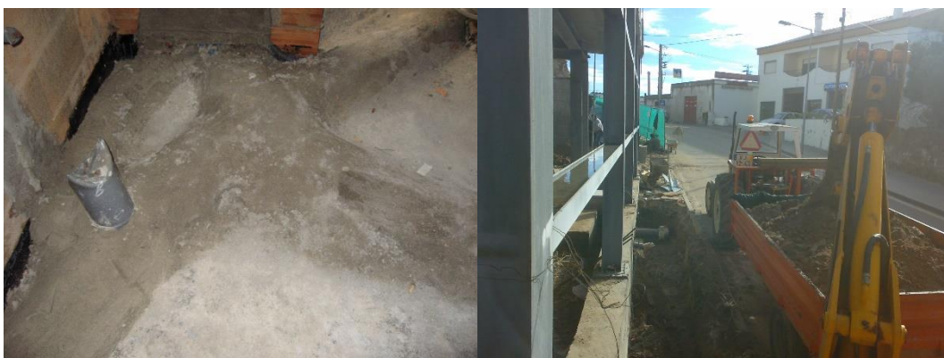
Figura 21 - Infraestruturas de drenagem de águas residuais
