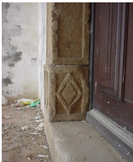
Figura 41 - Dejetos dos pombos no revestimento do pavimento da Galilé
