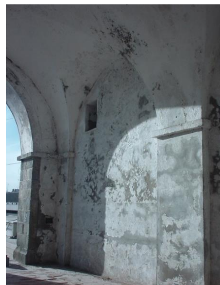
Figura 40 - Manchas de humidade nas paredes da Galilé
