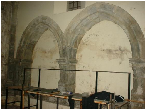
Figura 42 - Eflorescências nas paredes interiores
