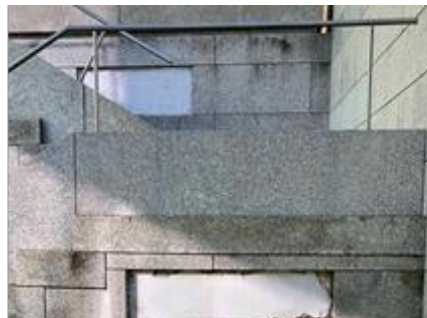
Figura 93 - Descolamento do revestimento em granito
