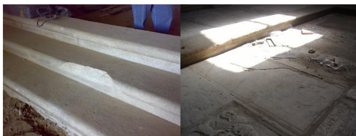
Figura 82 - Danos provocados pelo empreiteiro no património
