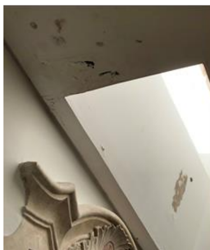
Figura 89 - Condensação nos tetos da área de Ampliação
