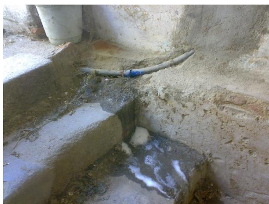
Figura 51 - Infraestruturas de drenagem de águas residuais no Convento
