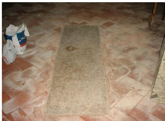
Figura 47 - Vestígios de humidade nos pavimentos
