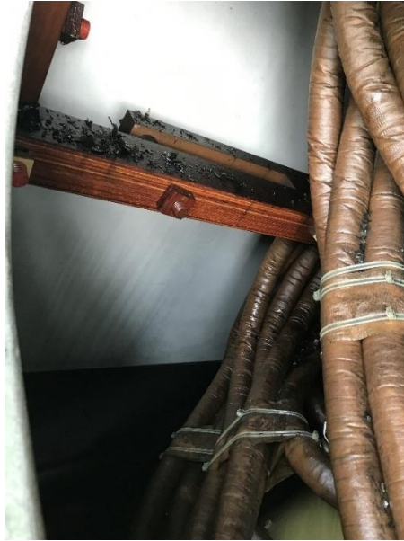
Figura 67 - Cuba do comutador de tomadas.
