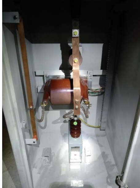
Figura 62 - Substituição da enclausura e o condensador da fase U.
