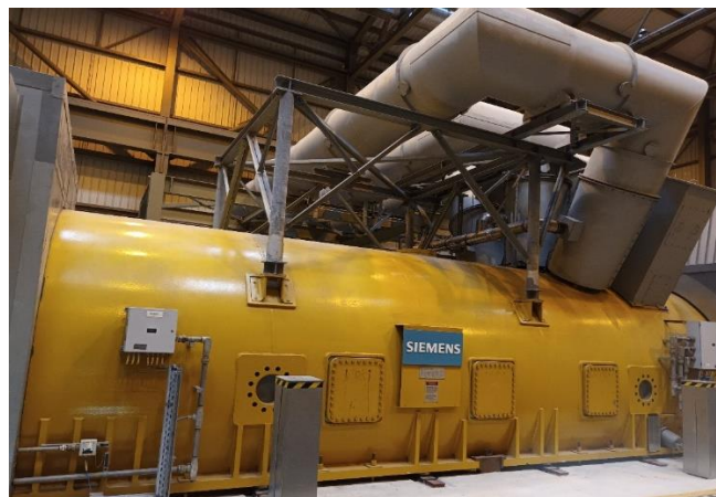
Figura 28 - Gerador SGEN5 – 2000H.
