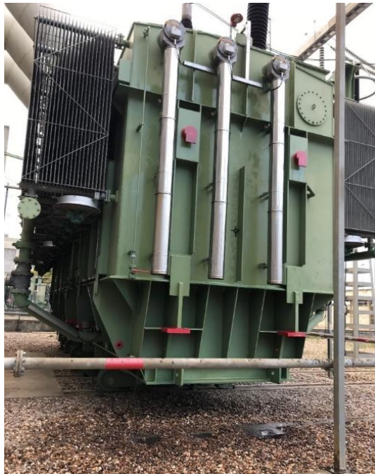
Figura 46 - Abertura das válvulas de descompressão.
