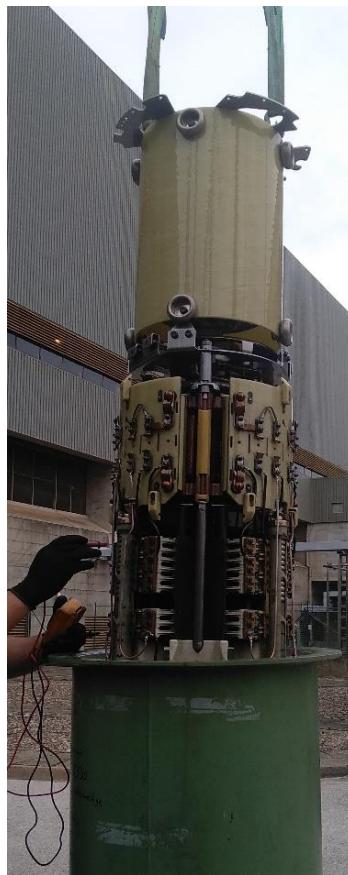
Figura 60 - Medições ao comutador de tomadas.
