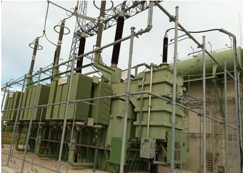
Figura 29 – Transformador instalado na central de ciclo combinado.
