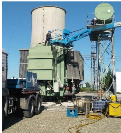
Figura 56 - Ligação hidráulica do transformador para o conservador.
