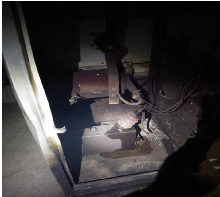
Figura 50 - Cella U do condensador do TT.
