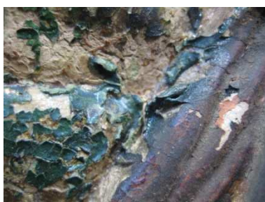
Imagem 66 - Risco de destacamento da policromia.
