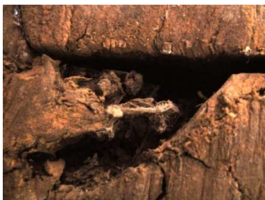
Imagem 62 - podridão da madeira na face lateral causada por ataque de fungos do elemento A.
