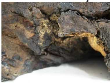
Imagem 63 - podridão da madeira na face lateral causada por ataque de fungos do elemento A.
