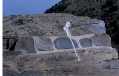
fig. 12 Rampa executada a título exemplificativo. A água tomará um outro curso e não permanecerá na rocha. Curiosamente, observa-se a presença de um dejecto animal (provavelmente ave de algum porte). Neste caso, singularmente, ajuda a perceber o novo rumo que a água tomará na superfície da rocha. Foto: Compósito.
