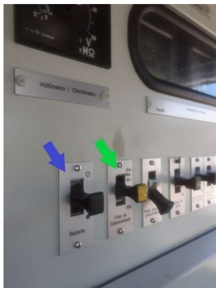
Figura 58 – Interruptor de alavanca para acionamento da bateria (assinalada pela seta azul) e o interruptor de alavanca para libertar o freio de estacionamento (assinalado pela seta verde), na UQE 2403/63 (foto no parque oficial de Campolide).
