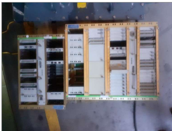
Figura 24 – Racks da Unidade de Controlo Central (UCC, à esquerda) e da Unidade de Controlo de Tração (UCT, à direita) retiradas da UQE 2300/2400 para manutenção (foto nas instalações da CP).
