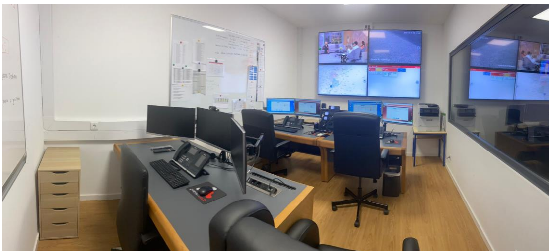
Figura 7 - Sala de Operações da CMOS (Fonte: CM Azambuja, 2022)
