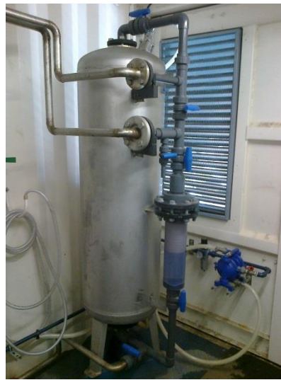
Figura 13 - Unidade de detecção de óleo
