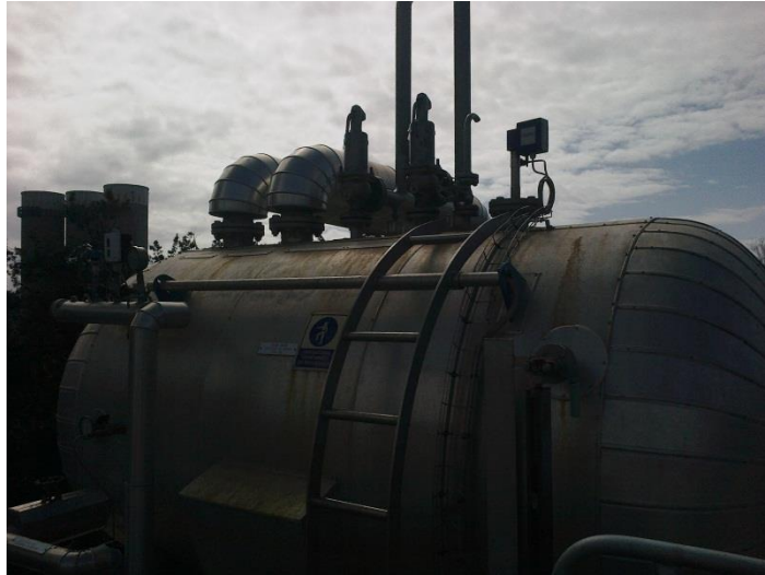
Figura 22 - Barrilete com válvulas de segurança
