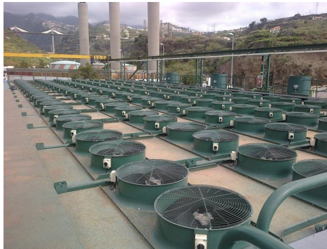
Figura 11 - Radiadores a ar
