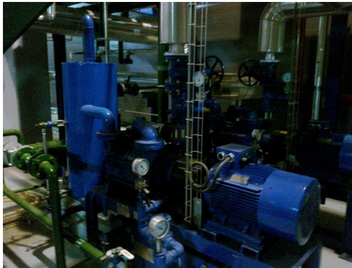
Figura 41 - Bombas de vácuo
