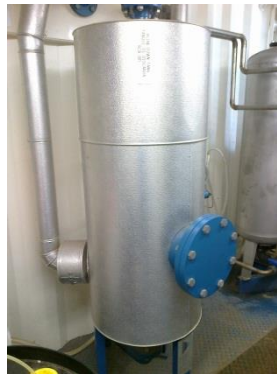
Figura 21 - Tanque de descarga
