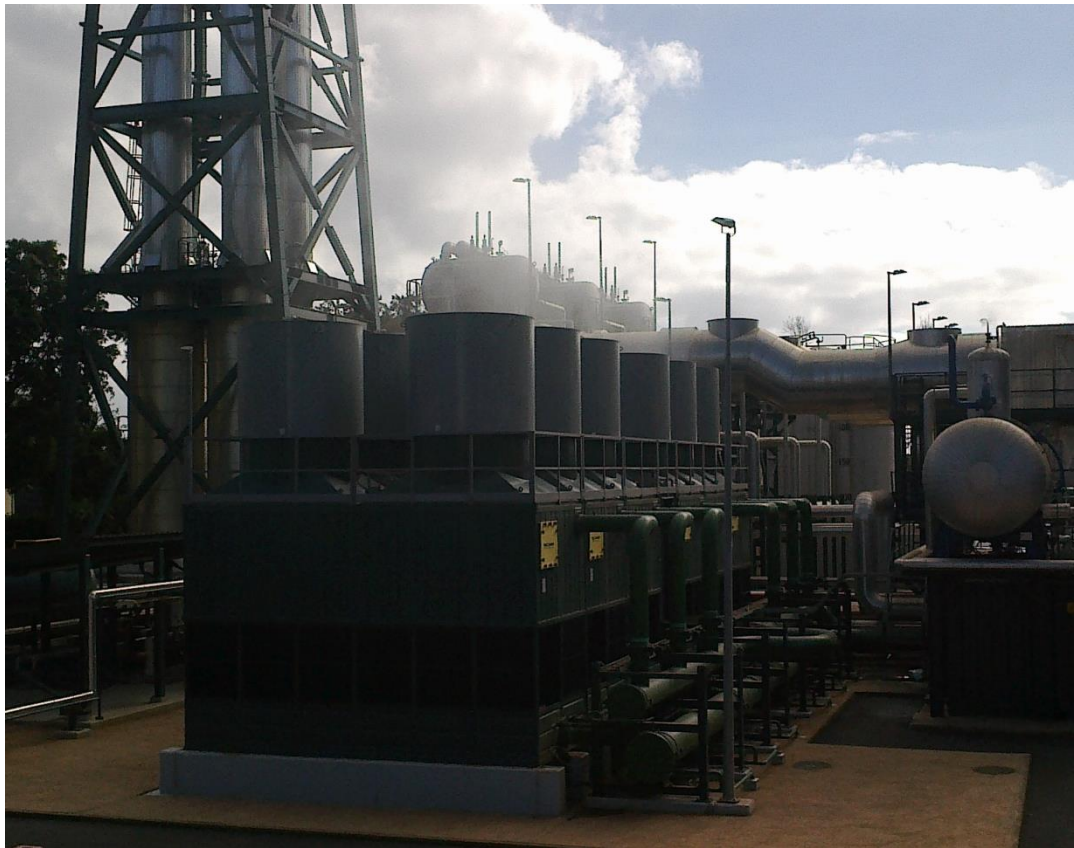
Figura 44 - Torres de refrigeração
