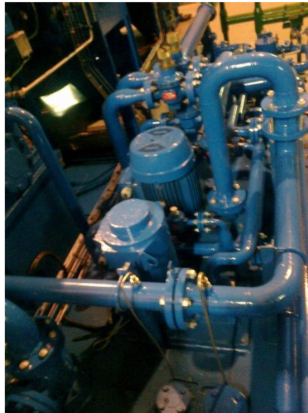
Figura 35 - Bombas de óleo auxiliar e de emergência
