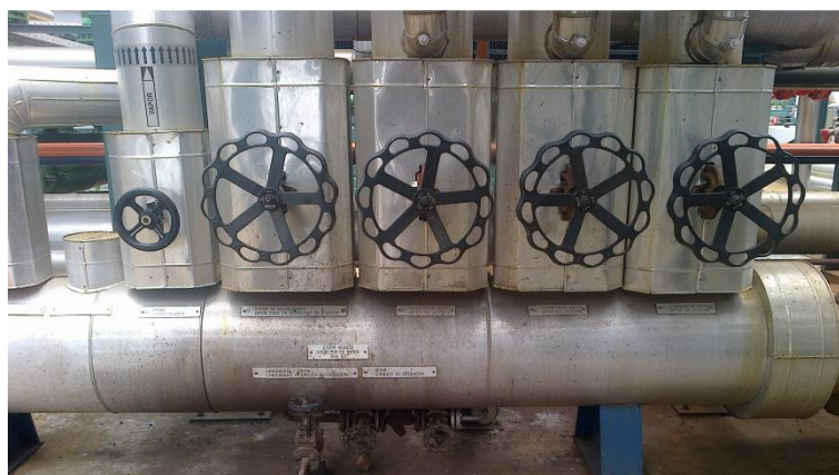
Figura 16 - Colector de vapor
