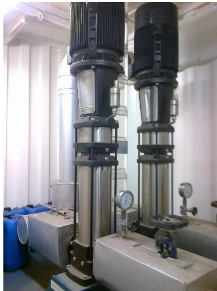
Figura 14 - Bombas de água condensada
