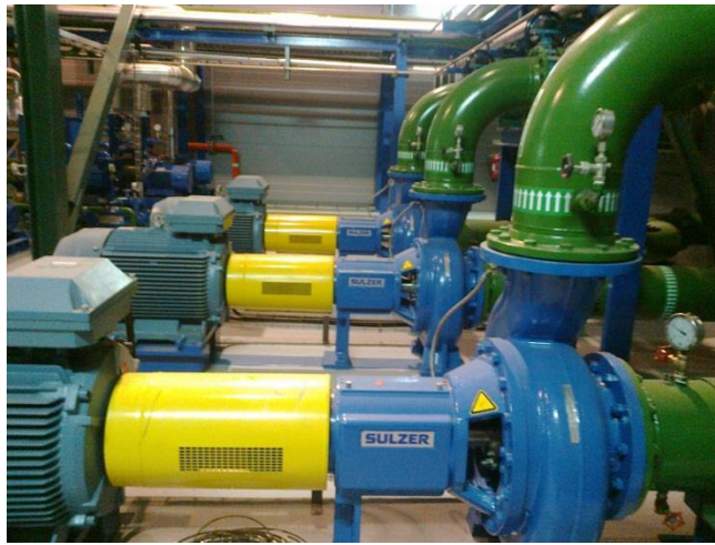
Figura 42 - Bombas do sistema de arrefecimento do condensador
