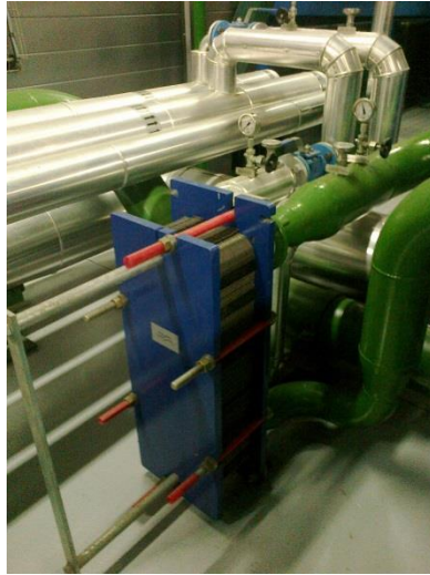
Figura 40 - Recuperação de calor do sistema de arrefecimento a água dos motores
