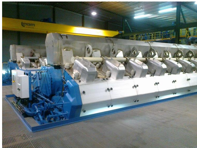
Figura 6 - Casa das máquinas
