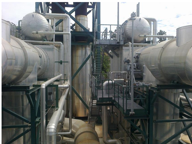
Figura 15 - Caldeiras de recuperação
