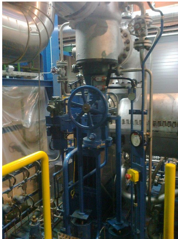
Figura 23 - Válvula de corte e de emergência
