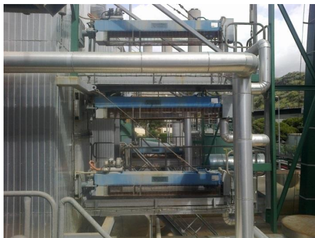
Figura 17 - Sopradores de fuligem
