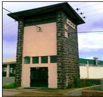
Figura 2.9. - Posto de transformação em cabine alta
