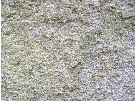
Degradação do granito
