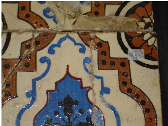
Azulejo fracturado e com lacuna de vidro
