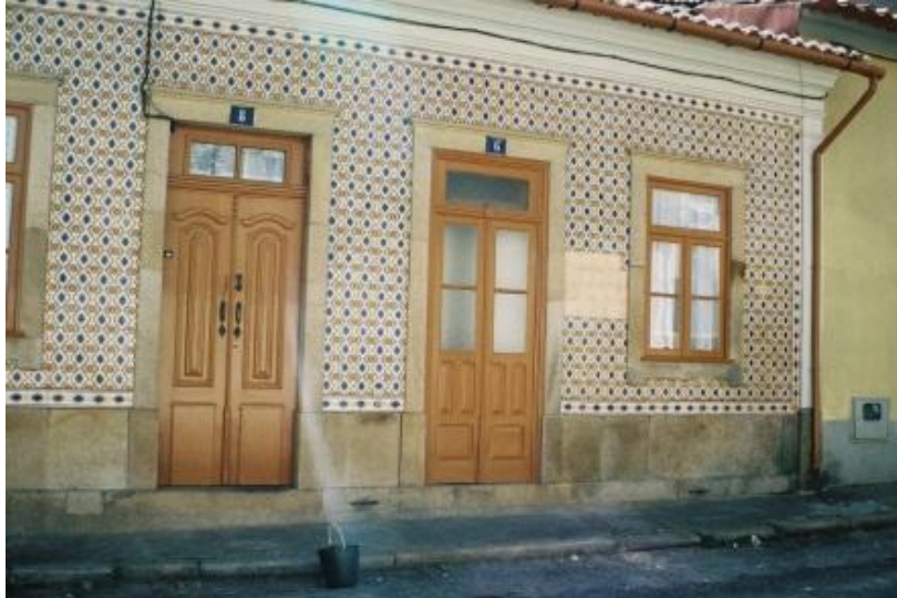
Aspecto geral da fachada após os azulejos terem caído e antes de se iniciar a intervenção
