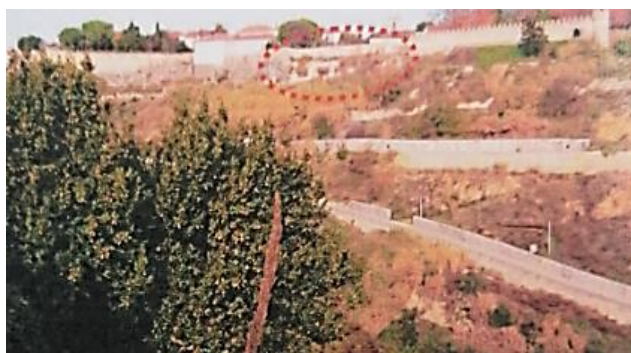
Figura 84 - Identificação da zona da muralha onde houve desprendimentos de blocos do topo da bancada calcária, zona adjacente às muralhas do jardim das Portas do Sol (PGEES, 2015)
