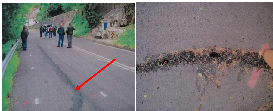
Figuras 85 - Localização das fissurações no pavimento da EN114 (PGEES, 2015)
