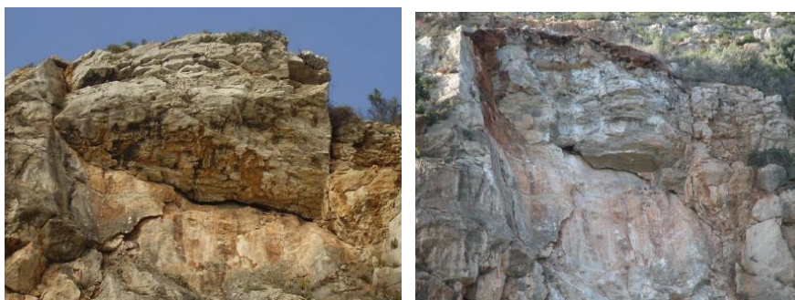
Figura 16 – Remoção de bloco calcário de grande dimensão em risco de queda (Coba, 2018)
