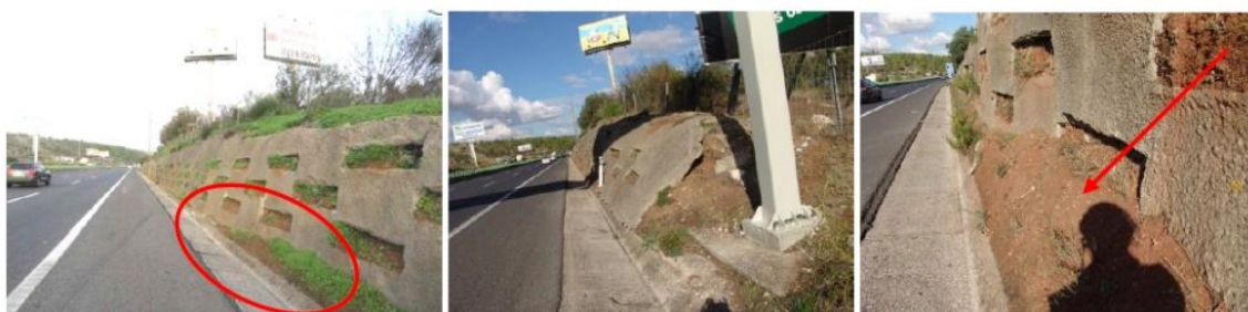
Figura 21 - Aspectos das patologias do talude com revestimento em betão com "janelas" (LCW Consult, S.A.) 2016)
