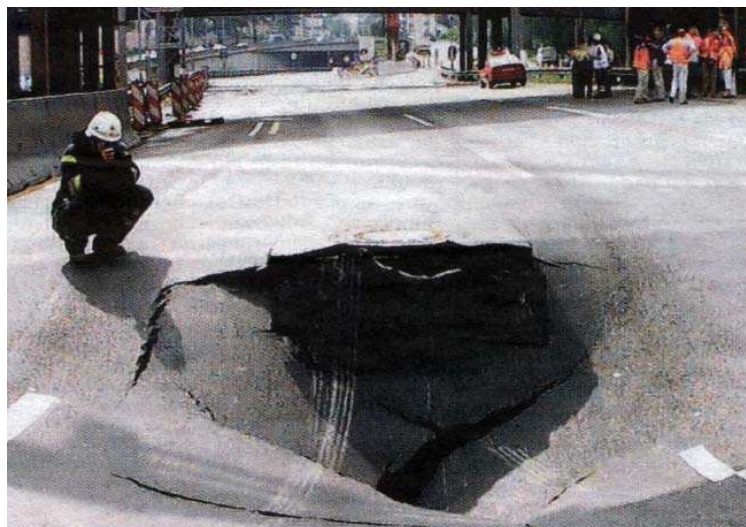
Figura 13 – Colapso de uma faixa de rodagem devido a uma rotura de água.
