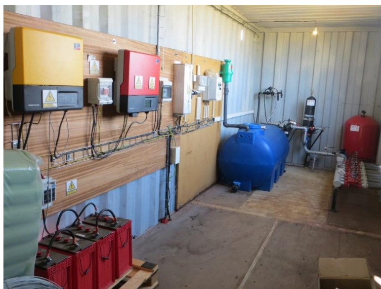
Figura 4.18. Equipamentos do sistema dentro do contentor marítimo de 50 pés.
