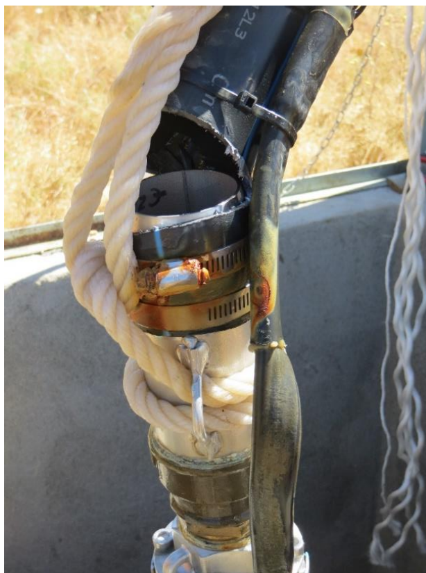
Figura 4.19. Identificação da avaria do sistema de bombagem solar.
