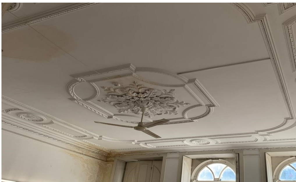
Figura 16 - Teto com infiltração
