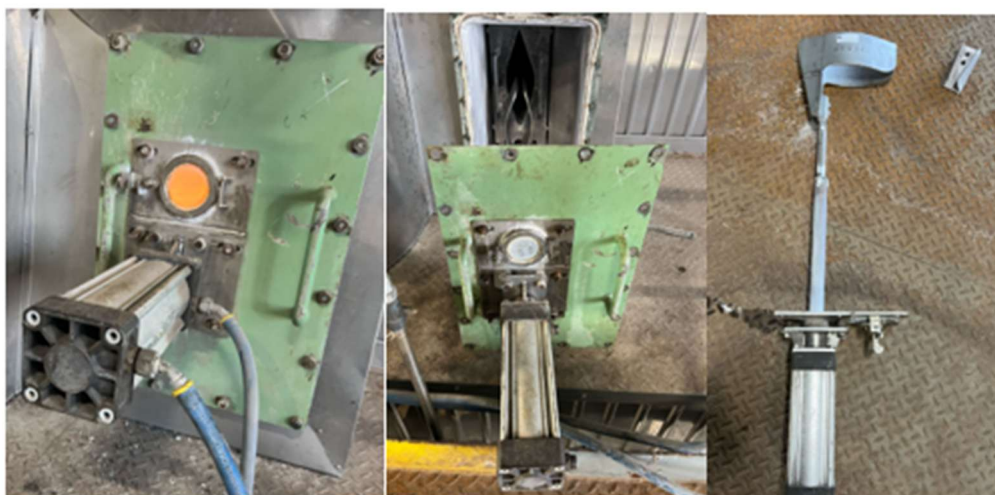
Figura 5.11 – Autómatos de limpeza de caldeira de recuperação.
