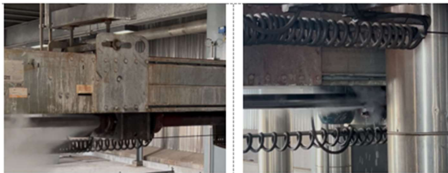
Figura 5.25 – Fuga na válvula polpet.
