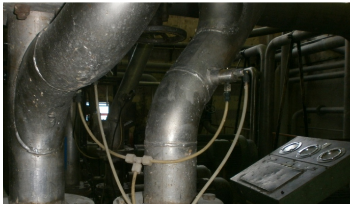
Figura 3.10. Conjunto de transmissores de pressão
