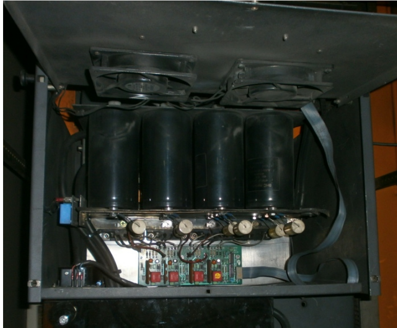
Figura 3.20. Condensadores e placa de impulsos
