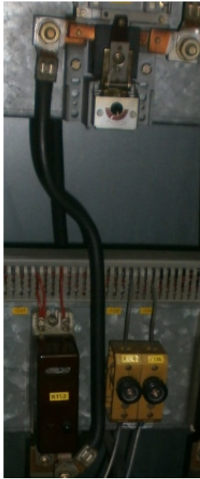
Figura 3.71. Proteção térmica e magnética
