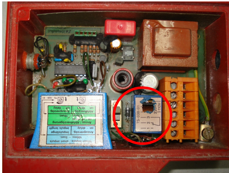
Figura 3.45. Interior da célula fotolétrica do scanner 2
