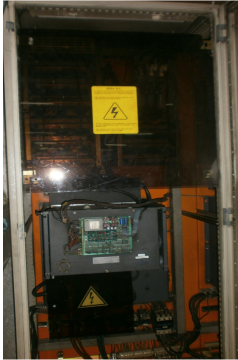
Figura 3.19. Quadro do acionamento de um motor da faca da cortadora
