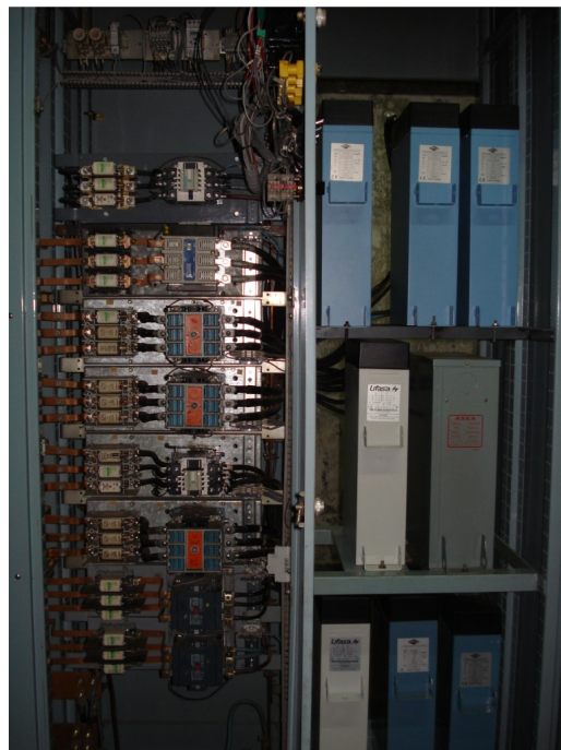
Figura 3.27. Bateria de condensadores
