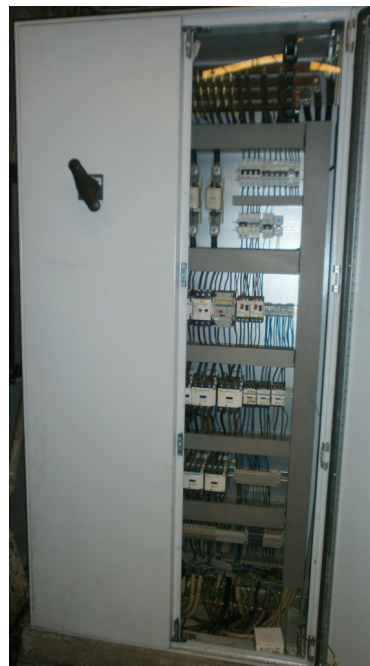
Figura 3.68. Novo quadro da E.T.A.R.I. mais recente
