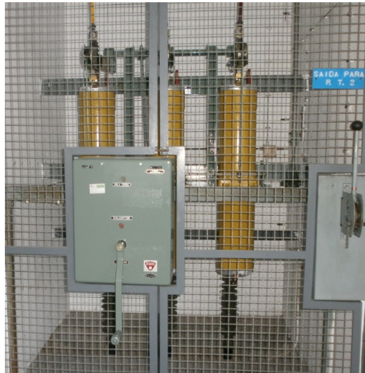
Figura 3.40. Disjuntor de 30000V para o PT2
