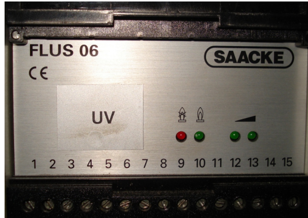
Figura 3.5. Relé de chama da caldeira
