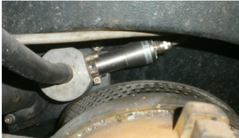
Figura 3.4. Sensor de chama da caldeira
