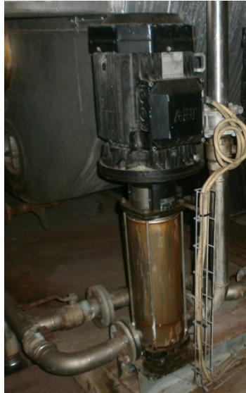
Figura 3.37. Bomba multicelular de abastecimento de água à caldeira
