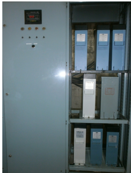
Figura 3.63. Quadro para compensação do fator de potência
