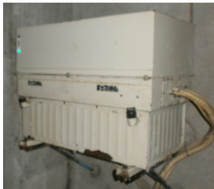
Figura 3.36. Reóstato de arranque do pulper do interior
