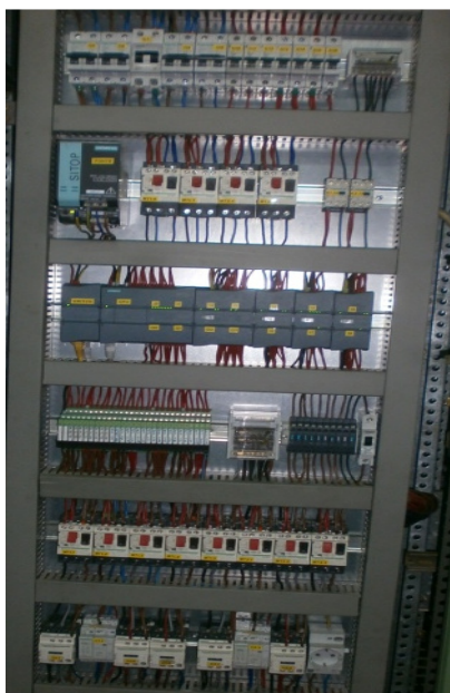
Figura 3.70. Quadro da unidade de comando do motor do veio geral
