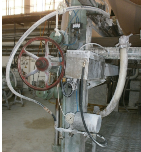
Figura 3.11. Rampa de lavagem de alta pressão (econo-jet)
