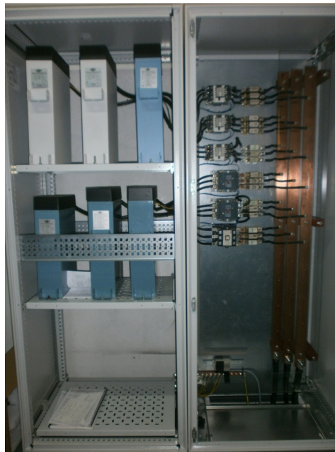
Figura 3.65. Novo quadro para compensação do fator de potência
