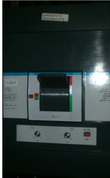
Figura 3.64. Disjuntor de proteção do novo módulo de baterias
